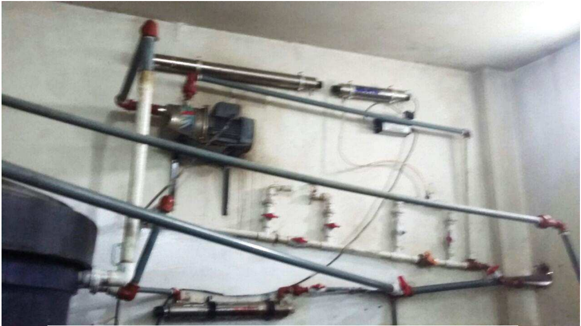
Desinfección por rayos UV
