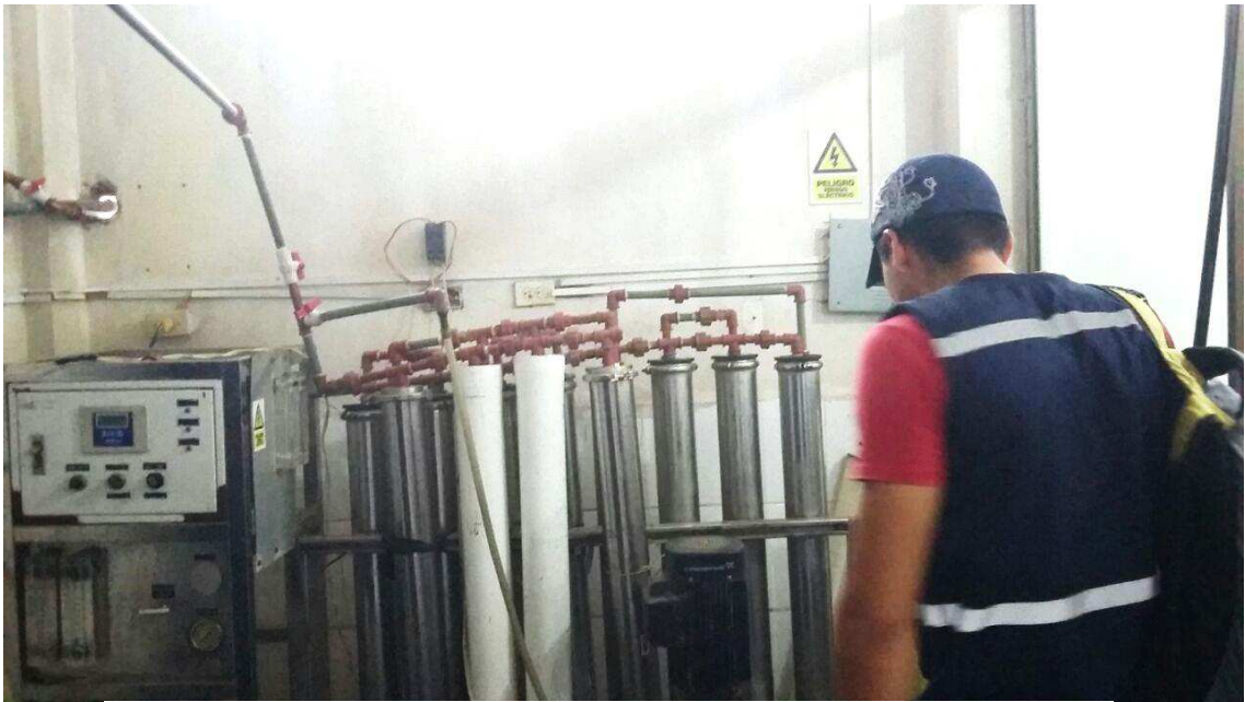
Equipo de osmosis inversa
