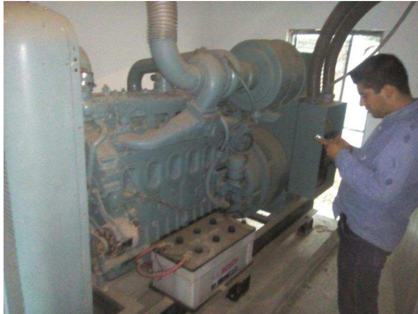
Figura del grupo electrógeno de la Universidad Laica Eloy Alfaro de Manabí Extensión Chone.
