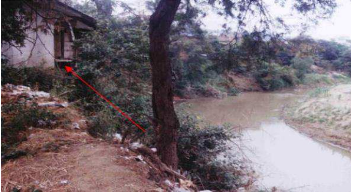
Anexo 3. Erosión del margen derecho de la cuenca del río Portoviejo.
