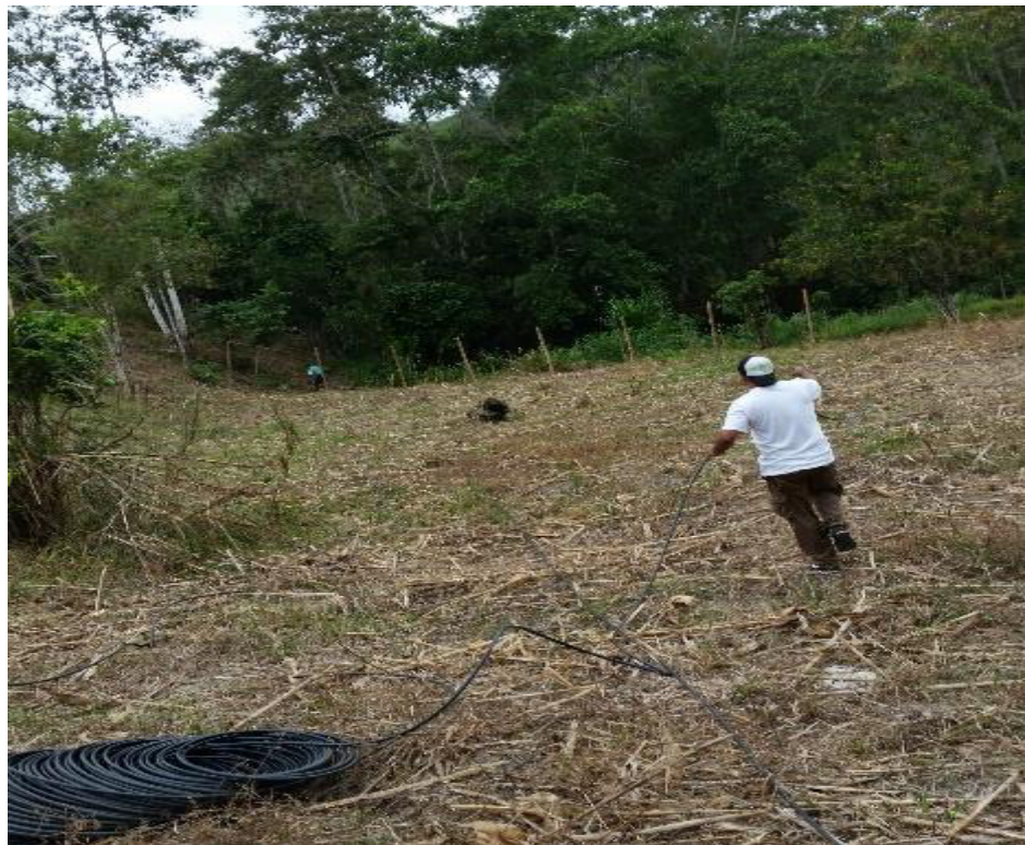
Anexo 2. Instalación de riego
