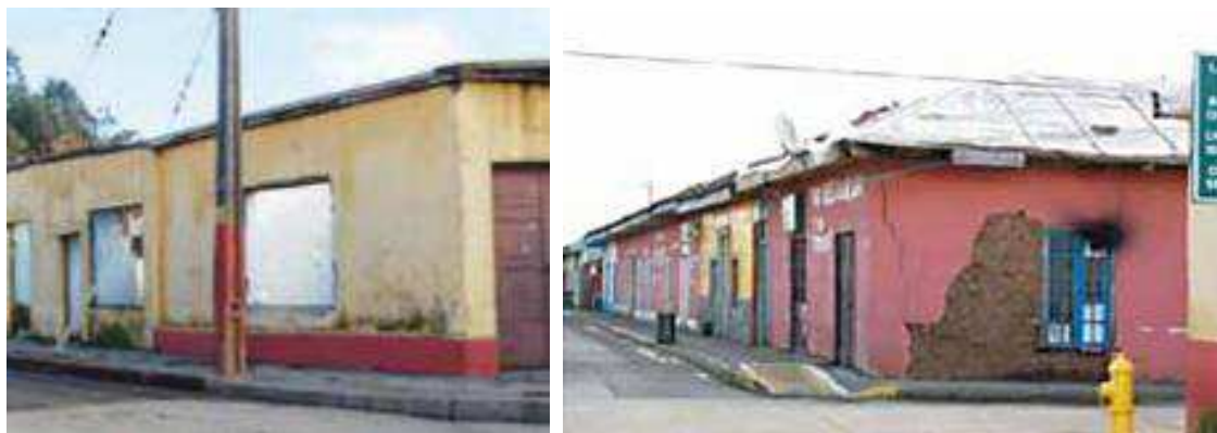
Imagen 17: daños severos en las viviendas tradicionales chilenas
