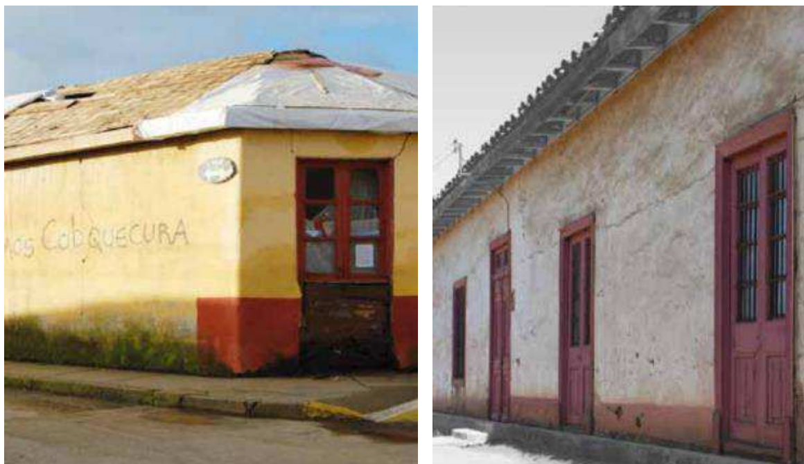
Imagen 16: viviendas con afectaciones externas por diversas causas.
