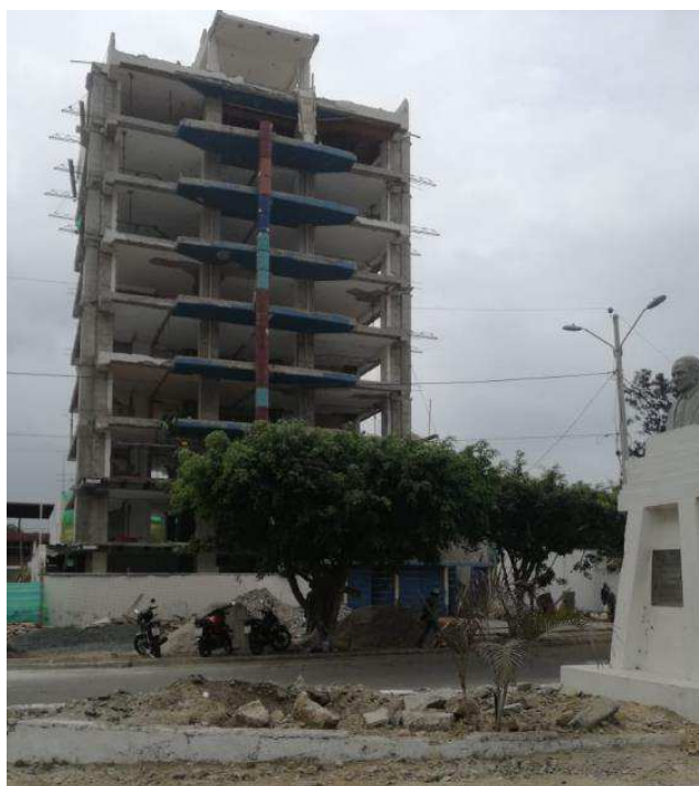
Anexo 3. Vista del área a intervenir. Deterioro de edificaciones Fuente: Investigador-Nathaly Intriago.
