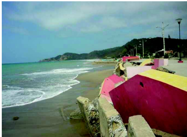
Foto 9 - Daños provocados por lluvias y oleajes en semana santa, 2018. Fuente: La Hora (2018)
