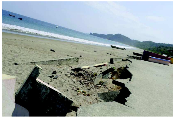
Foto 8 - Malecón de Salango afectado por fuertes oleajes. Fuente: La Hora (2019)
