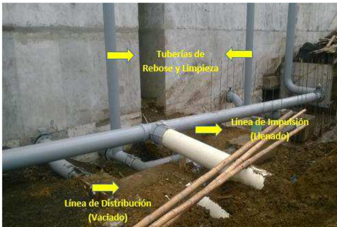
Figura A1.1. Tanques nuevos (4000 m 3 cada uno) Fuente: Elaboración propia
