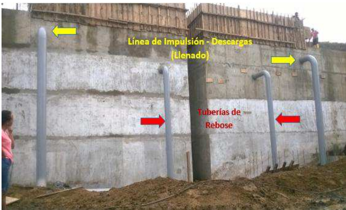
Figura A1.2. Descarga y rebose en los tanques nuevos Fuente: Elaboración propia
