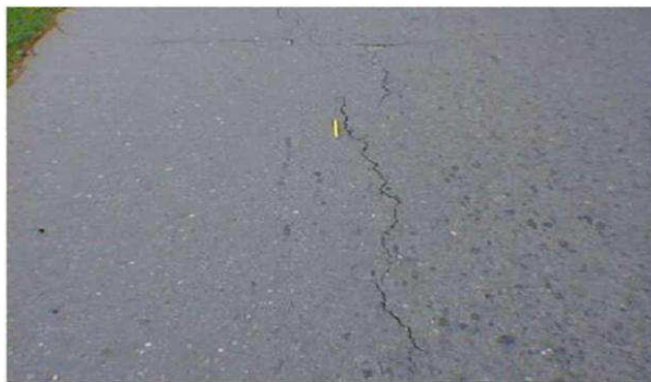
Figura 18. Fisuras y grietas longitudinales y transversales.
