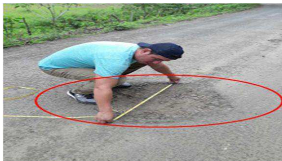
Figura 21. Baches en carpetas asfálticas y tratamientos superficiales.
