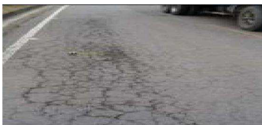
Figura 15. Fisuras y grietas por fatigamiento.
