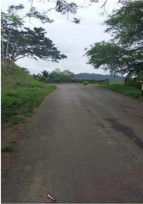
Presencia de ondulaciones
