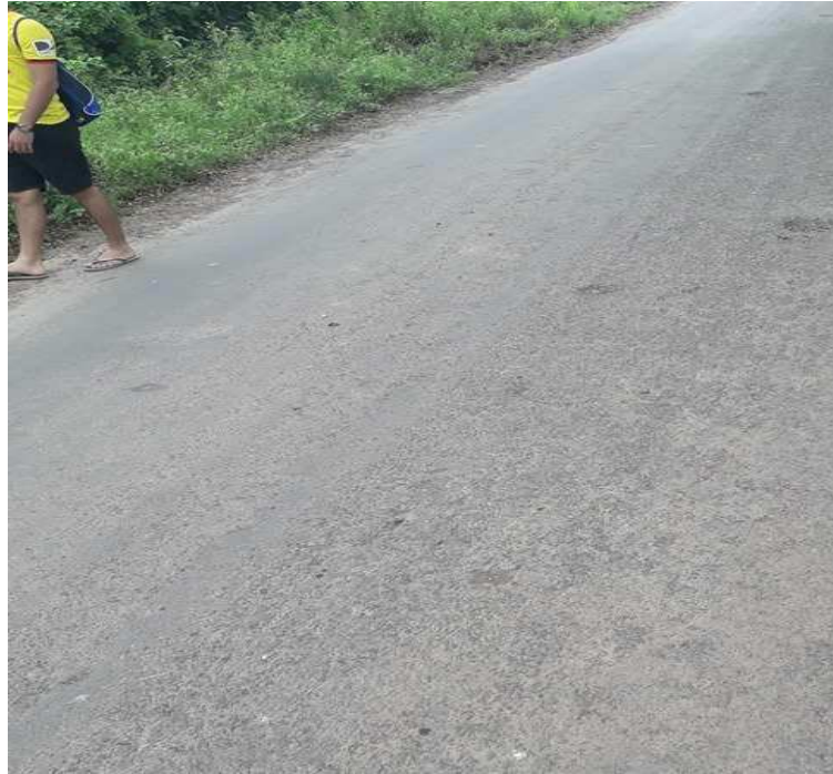
Fisuras y grietas longitudinales y transversales
