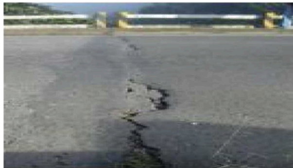
Figura 19. Fisuras y grietas Reflejadas.
