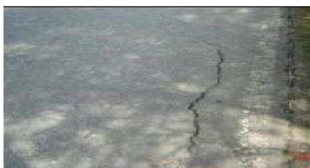
Figura 17. Grietas de borde.
