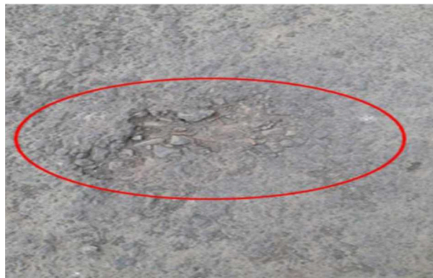
Figura 26. Pérdida de áridos.
