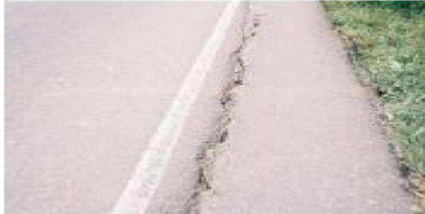
Figura 30. Separación entre berma y pavimento.
