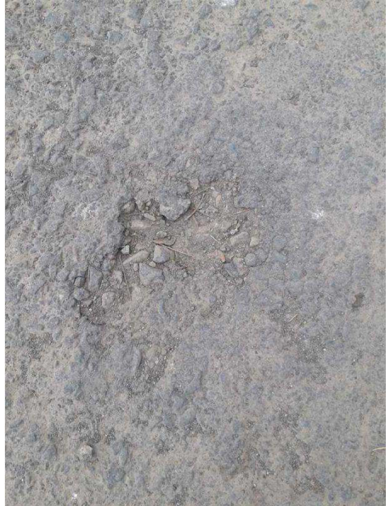
Perdida de áridos en el asfalto
