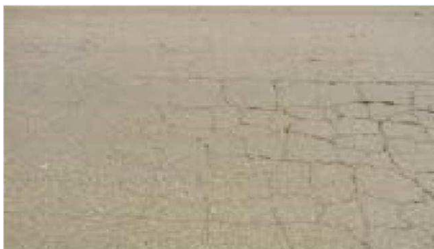
Figura 16. Fisuras y grietas en bloque.
