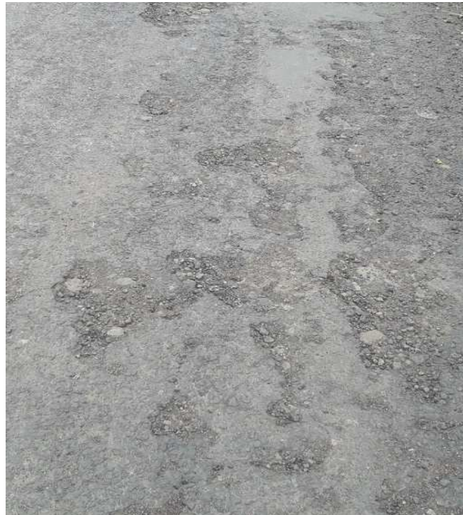
Desgaste en el asfalto
