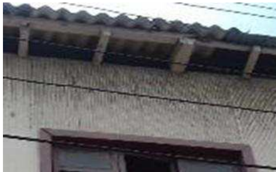
Imagen 4: Suciedad en cerramiento
