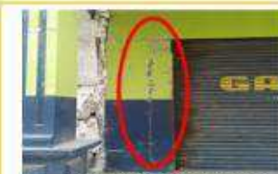
Fig.2 Desprendimiento de material.
