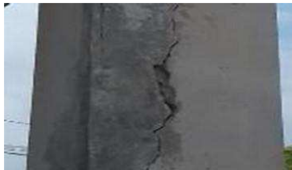
Imagen 7: Grietas en columna
