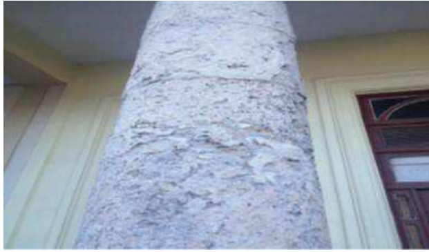
Imagen 5: Erosión en columna
