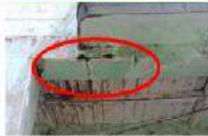
Fig.1 Corrosion, Fisura, Humedad.
