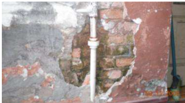
Imagen 13: Patologías provocada por rotura de tubería.
