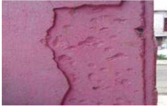
Imagen 9: Desprendimiento en columna
