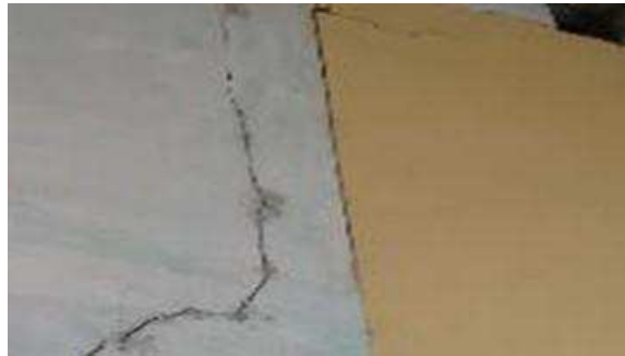
Imagen 8: Fisura en cerramiento
