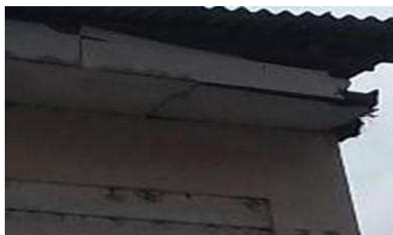
Imagen 6: Deformación en cubierta.
