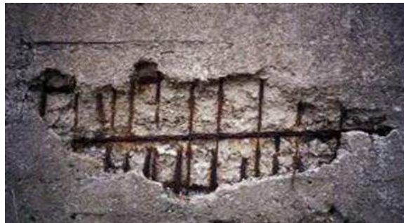
Imagen 2: Corrosión de metales.
