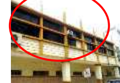
Fig. 6- Derrumbe de edif.
