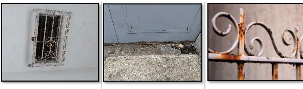
Figura 8: Pérdidas de Material metálico debido a la Oxidación
