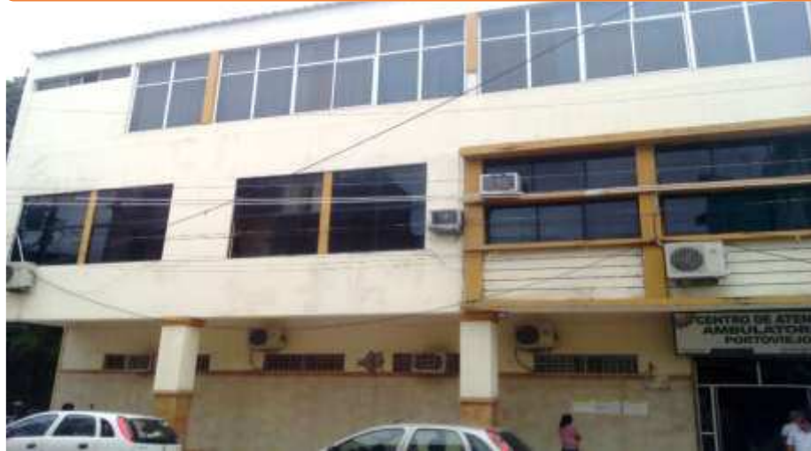
FOTO DE LOS AUTORES DESPUÉS DEL TERREMOTO (2016) FACHADA SECUNDARIA
