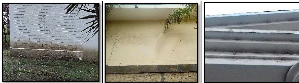
Figura 3: Acumulación de Suciedad en Paredes y Voladizo
