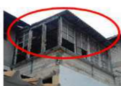
Fig. 2-Plagas y falta de ele.
