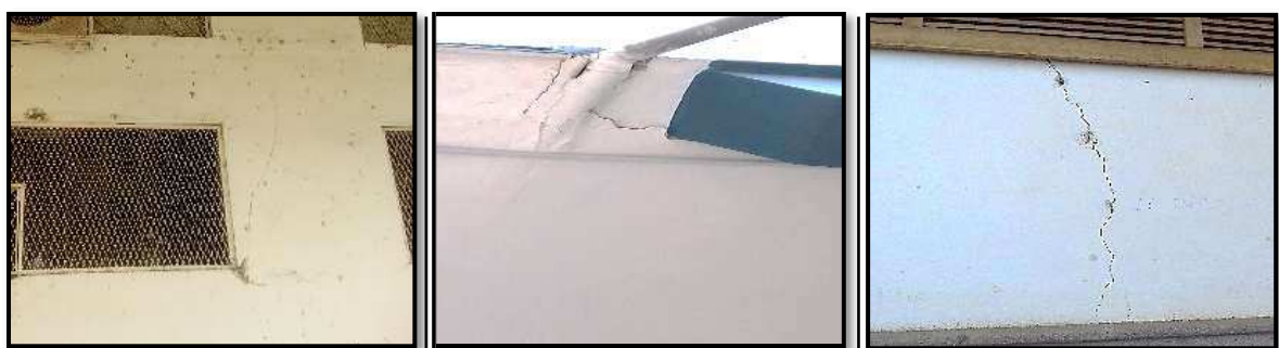
Figura 5: Aparición de Fisuras
