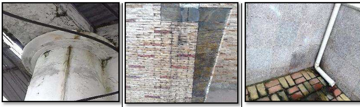
Figura 1: Humedad en Soportes Verticales, Enchapes y Paredes
