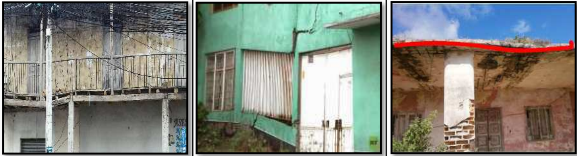
Figura 4: Múltiples Lesiones y Deformación Física y Estructural en la Edificación
