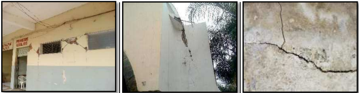
Figura 6: Grietas en diversas formas Verticales y Horizontales
