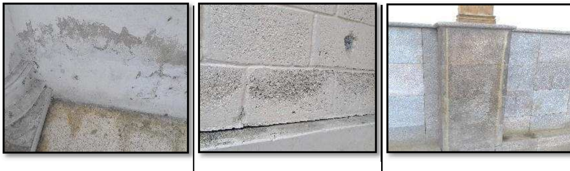
Figura 2: Erosión en Columnas y Paredes
