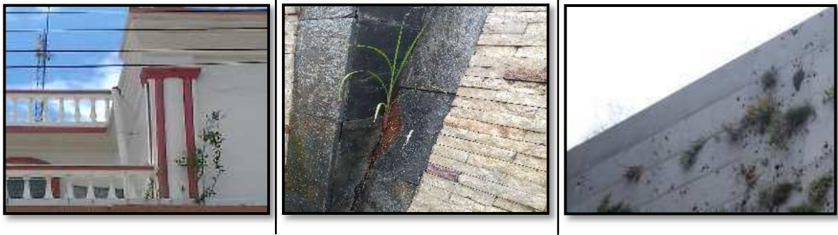
Figura 9: Aparición de organismos en Fachadas varias
