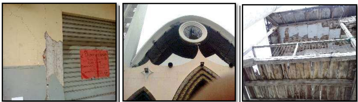
Figura 7: Desprendimientos en diferentes partes de las estructuras
