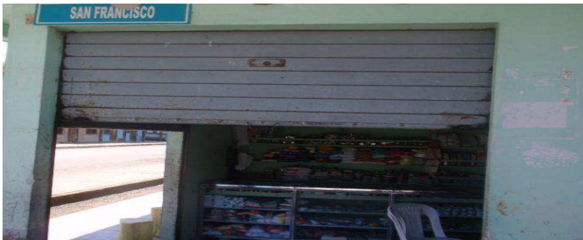
Figura 10. Oxidación de elemento metálico.
