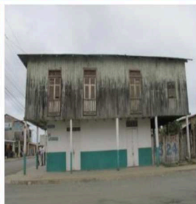
Fig 4. Presencia de manchas
