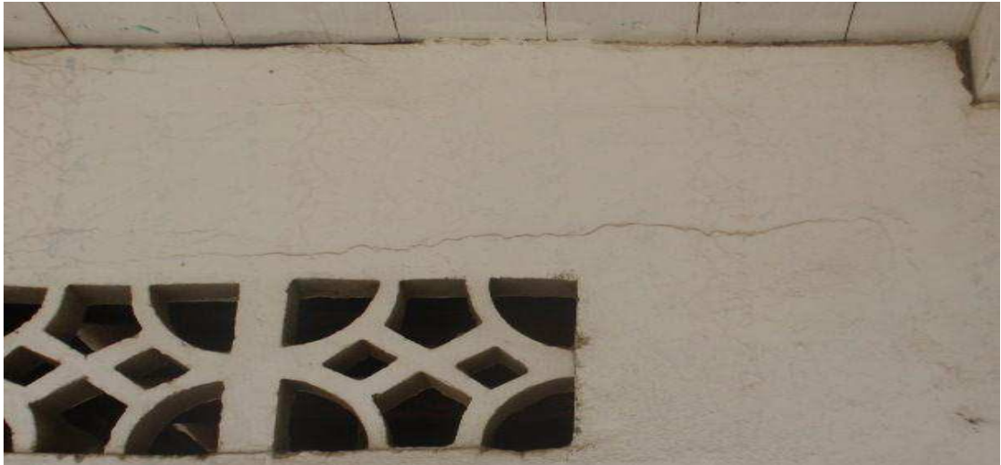
Figura 6. Fisura en la pared. Fuente: Los autores.
