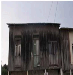
Fig 3. Presencia de manchas
