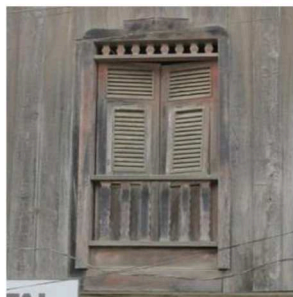
Fig 3. Presencia de manchas
