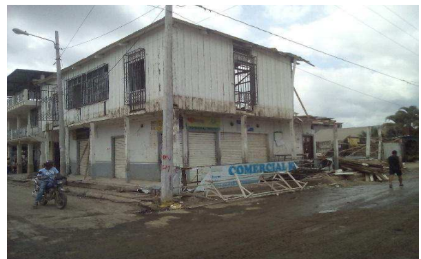
d) Colapso de vivienda en el terremoto 16 A. Fuente: Los autores.
