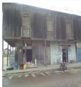
Fig 3. Presencia de manchas
