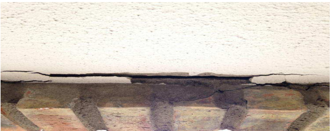
Figura 18. Desprendimiento en viga. Fuente: www.soloarquitectura.com .
