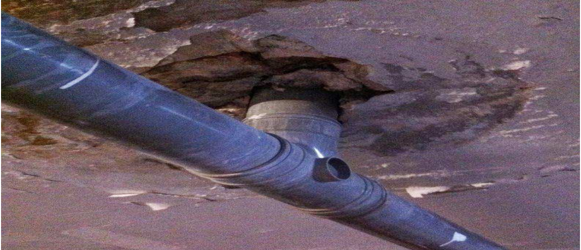
Figura 17. Humedad en acabados. Fuente: aimtallerdearquitectura.blogspot.com .
