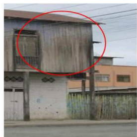
Fig 3. Manchas de humedades
