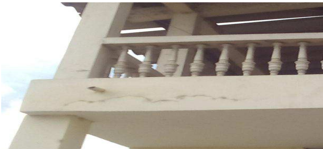
Figura 7. Grieta en viga. Fuente: Los autores.
