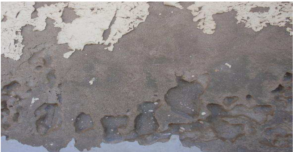
Figura 4. Erosión en hormigón.
