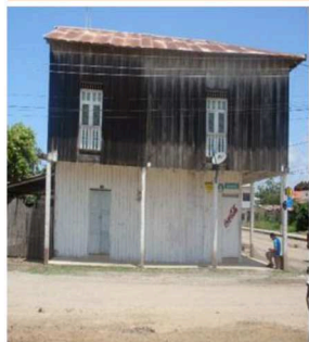
Fig 3. Presencia de manchas
