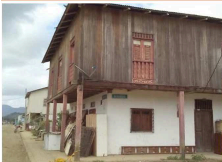
Fig 3. Presencia de manchas
