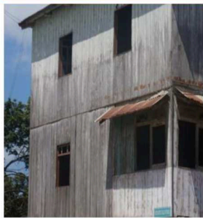
Fig 3. Presencia de manchas
