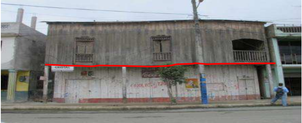
Figura 8. Deformación de viga en madera. Fuente: Los autores.
