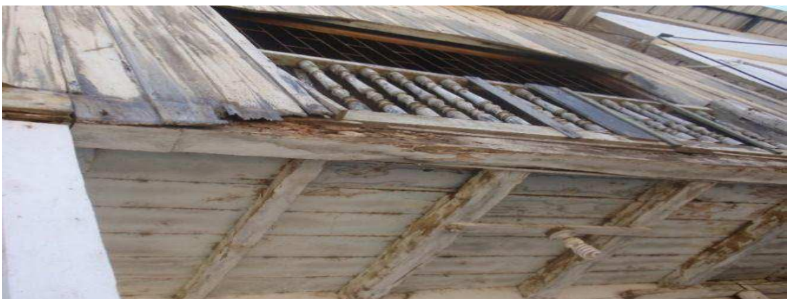
Figura 9. Desprendimiento de madera. Fuente: Los autores.
