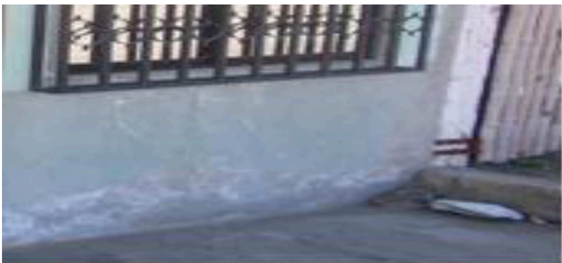
Figura 3. Humedad por capilaridad.
