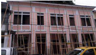
Foto después del terremoto del 2016
