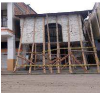
Foto después del terremoto del 2016
