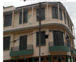
Figura 4: Mal estado de la capa protectora
