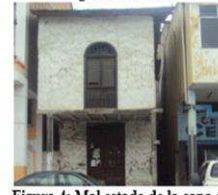
Figura 4: Mal estado de la capa de protección
