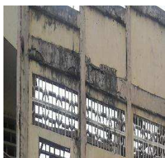
Figura 12: Humedad en la parte baja de un muro. Fuente: Las Autoras
