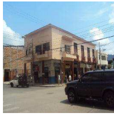
Figura 7: Lesión en acabados.
