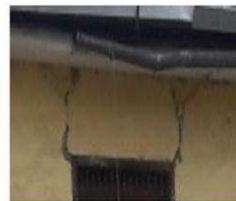
Figura 2: Fisuras y grietas
