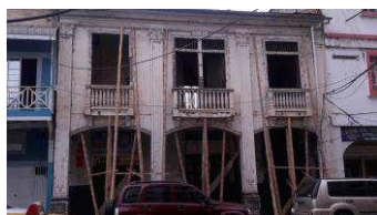
Foto después del terremoto del 2016
