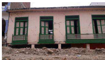
Foto después del terremoto del 2016
