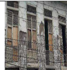
Mal estado de la carpintería
