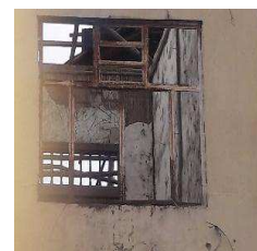
Figura 15: Corrosión de los elementos metálicos. Fuente: Las Autoras
