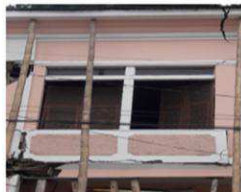
Figura 1: mal estado de la capa de protección
