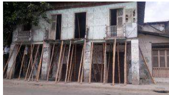
Foto después del terremoto del 2016
