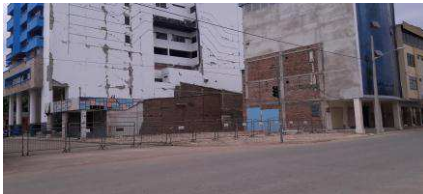
Foto después del terremoto del 2016
