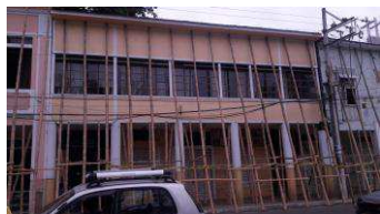
Foto después del terremoto del 2016
