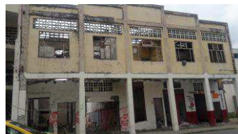
Foto después del terremoto del 2016
