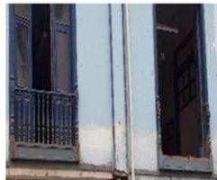
Figura 3: Mal estado de la carpintería
