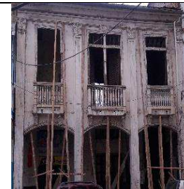
Suciedad y pérdida de color
