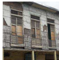
Figura 11: Lesión por desprendimiento.
