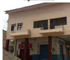
Figura 4: Mal estado de la capa de proteccion
