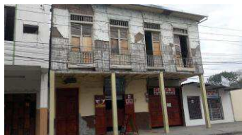
Foto después del terremoto del 2016
