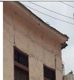
Grietas y deformaciones
