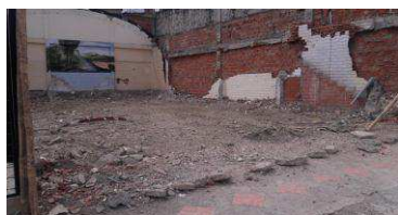
Foto después del terremoto del 2016
