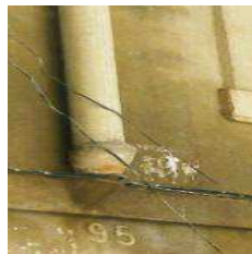
Figura 10: Lesiones por instalaciones.
