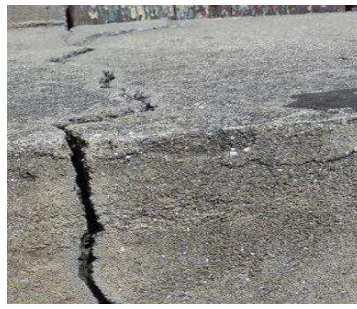
Figura 1.7.- Lesión por grietas. Fuente la autora.
