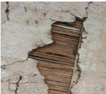
Figura 1.6.- Lesión por desplome. Fuente la autora.
