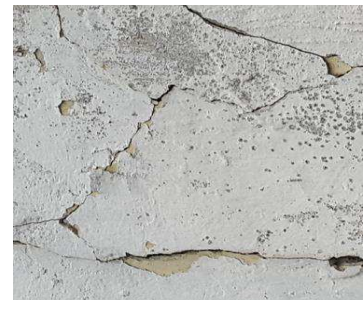
Figura 1.8.- Lesión por fisuras. Fuente la autora.
