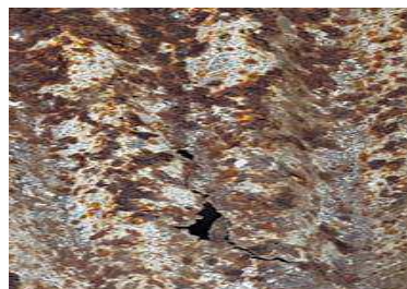
Figura 1.12.- Lesión Química por corrosión. Fuente la autora.
