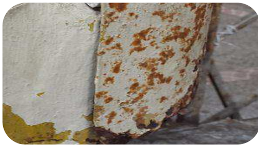
Oxidación: Lesión creada por la transformación en óxido al tener contacto con el oxígeno en la superficie de los materiales (Figura 1.20).
