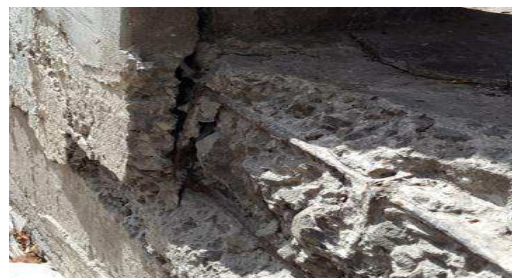
Figura 1.10.- Lesión mecánica por erosión. Fuente la autora.
