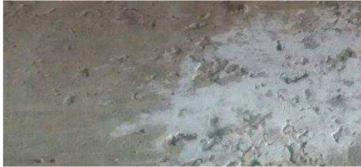
Figura 1.19.- Lesión química por eflorescencia en ladrillo. Fuente la autora.
