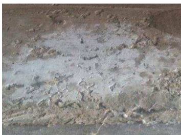
Figura 1.11.- Lesión Química por eflorescencia. Fuente la autora
