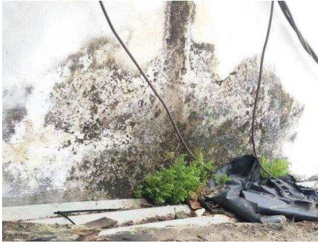
Figura 1.3.- Lesión por humedad. Fuente la autora.
