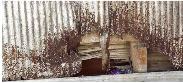
Figura 1.7.- Lesión física por erosión atmosférica. Fuente la autora.
