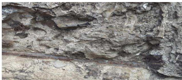
Figura 1.18.- Lesión mecánica por erosión. Fuente la autora.
