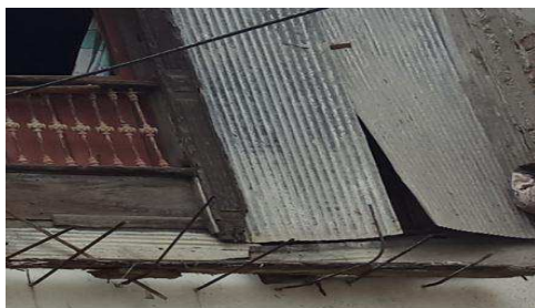
Figura 1.9.- Lesión por desprendimiento. Fuente la autora.
