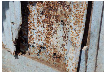
Figura 1.5.- Lesión física por erosión atmosférica. Fuente la autora.
