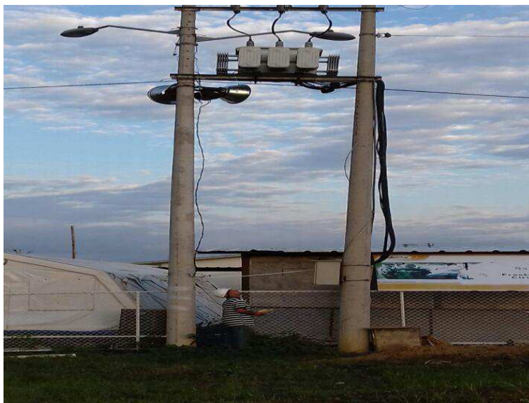
Observando conexión de banco de transformador trifásico
