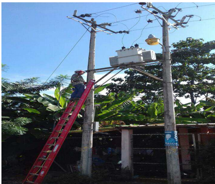
Observando conexión de banco de transformador trifásico
