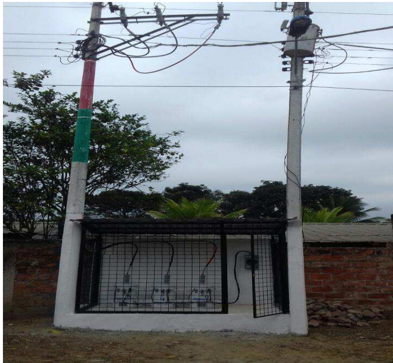
Culminación del banco de transformadores.
