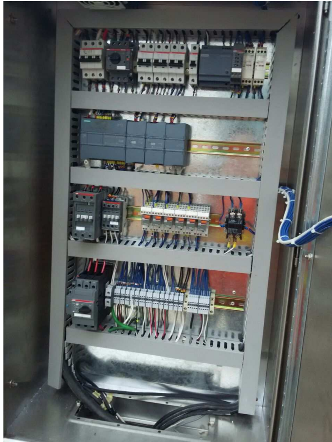
Figura 28 - Tablero y elementos de control de la planta purificadora de agua
