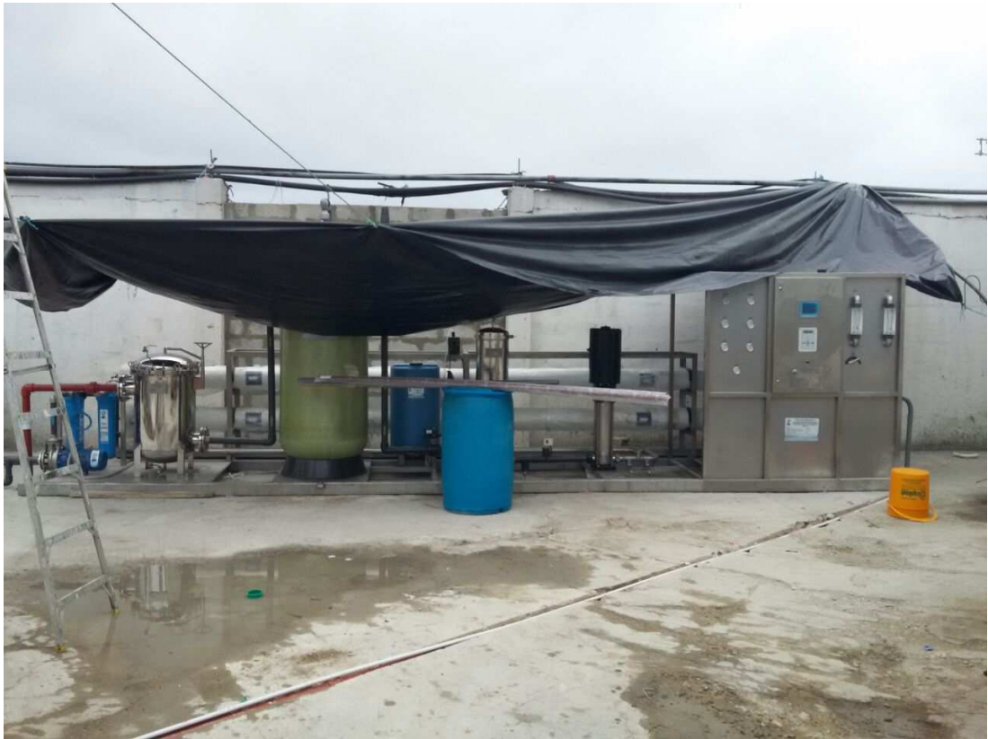
Figura 27 - Planta purificadora de agua por osmosis inversa
