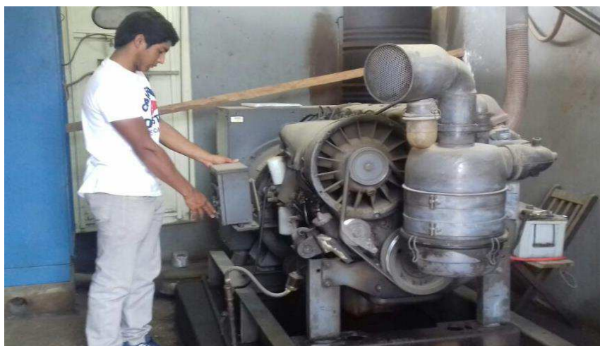
Figura del Grupo electrógeno de la casa deportiva La Moderna
