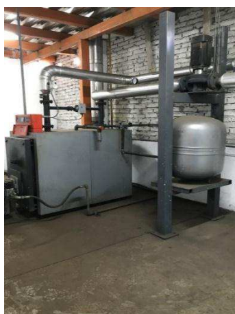
Foto 10. Calefactor de aire
