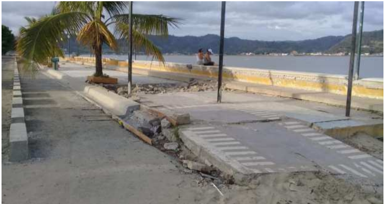
Ilustración 107: Espacios peatonales inaccesibles – Malecón Alberto Santos Fuente: Investigador
