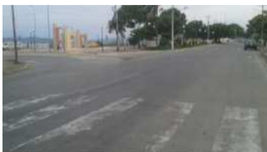
Ilustración 64: Paso cebra poco visible en la vía 1 Fuente: Investigador
