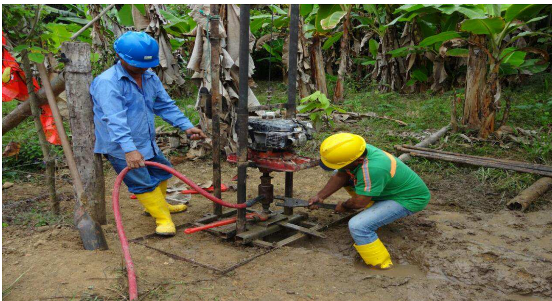
Grafico 16: Empresa dedicada a varias actividades entre ellas la perforacion de pozos de agua. Fuente: CEVCAL S.A
