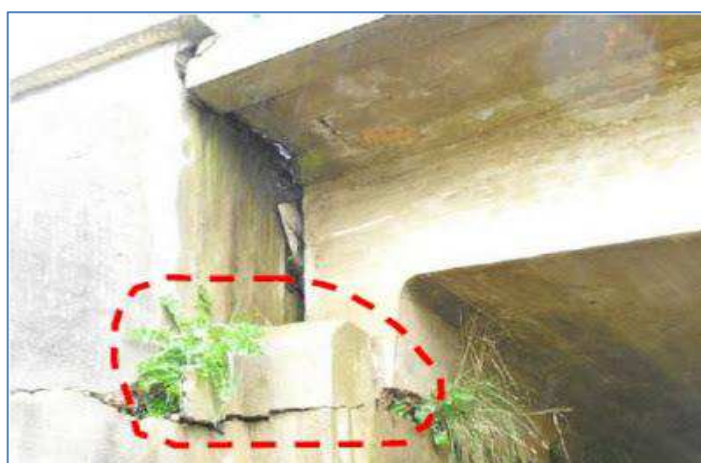
Figura # 1.5: Grietas en la base de un puente.
