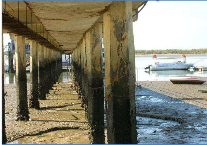
Figura # 1.6: Base de un puente corroído en su hormigón por efecto del agua.
