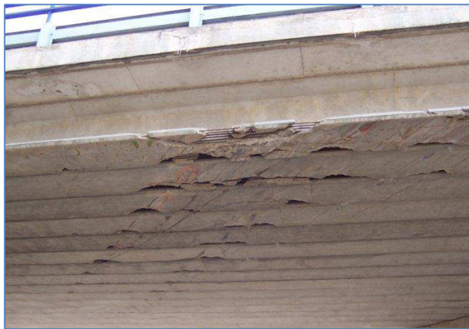
Figura # 1.7: Fallas en la base del área de transito de un puente vial.
