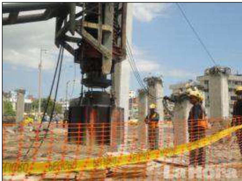
Figura 2.5 Hincado de Pilotes en Intercambiador de Tránsito Manta. Fuente: Diario La Hora
