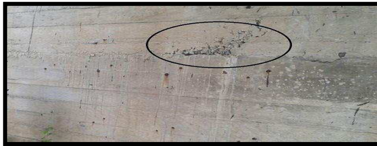
Figura 2.8. Erosión en el estribo derecho.
