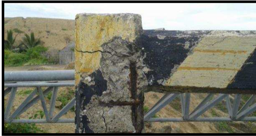
Figura 2.5. Desprendimiento del hormigón.
