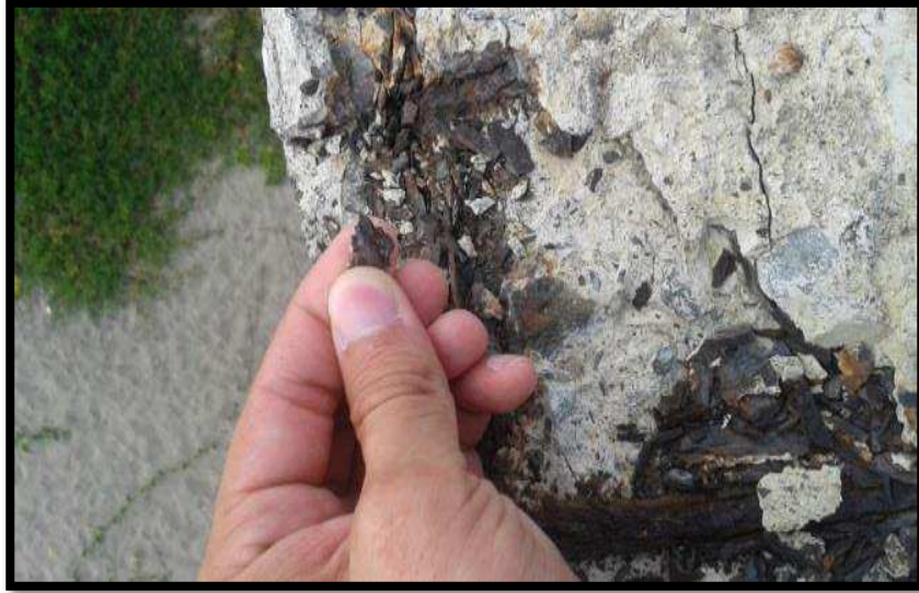
Figura 2.4. Corrosión del acero de refuerzo.
