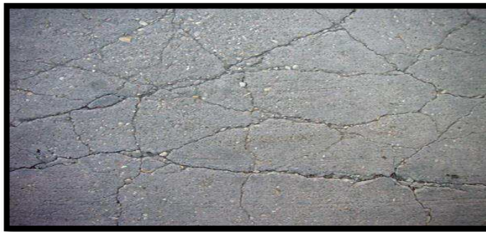
Figura 1.2. Fisuras por retracción plástica
