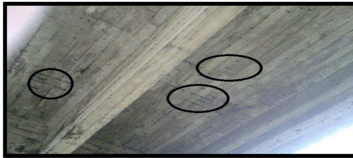
Figura 2.11. Perceptibilidad y corrosión en el acero de refuerzo del tablero.
