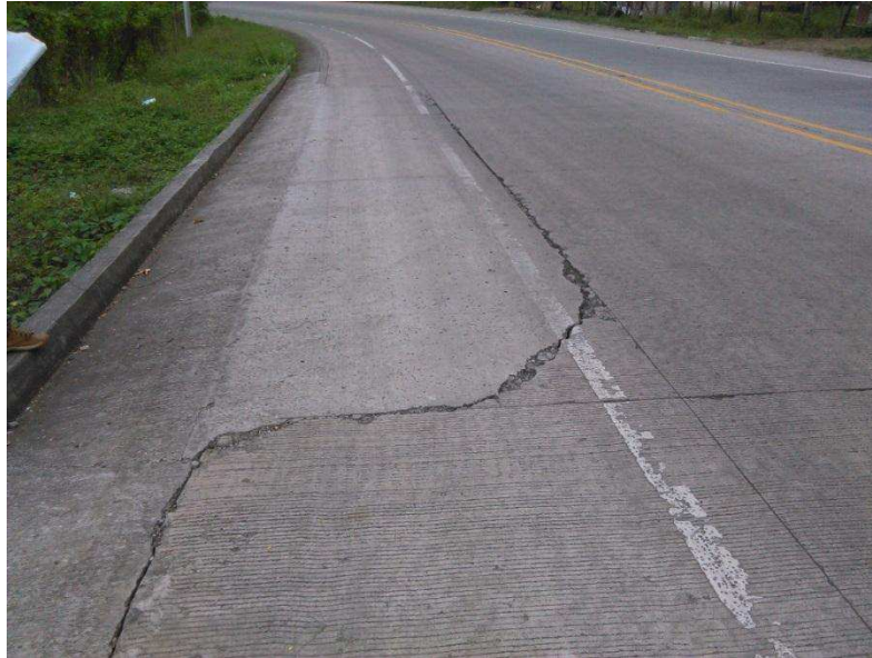
Imagen 7. Fisura transversal y daño en juntas de la vía Pavón-Flavio Elaboración: Los Autores
