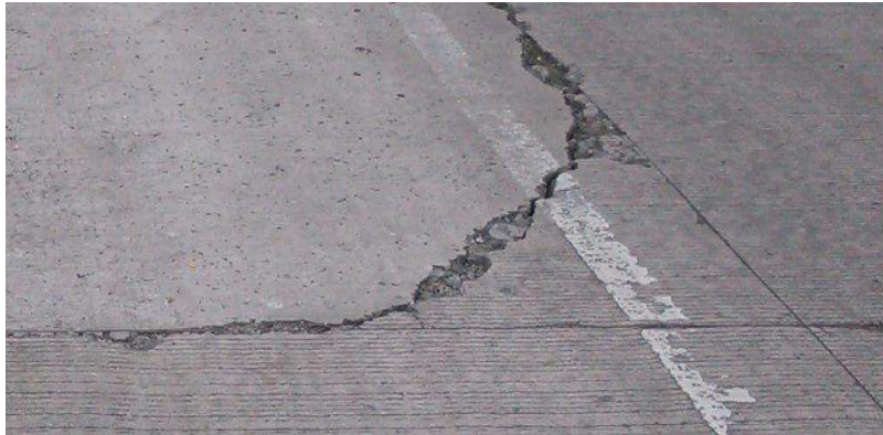
Grieta en esquina de la vía Pavón-Flavio Abscisa 22+150
