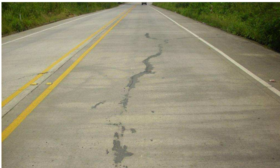
Imagen 5. Fisura longitudinal en varios paños de la vía Pavón-Flavio
