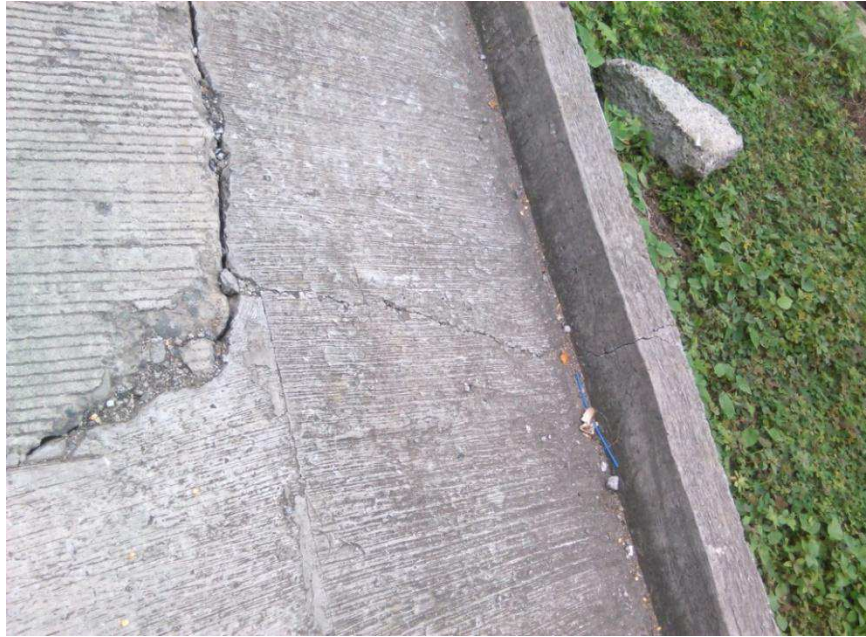
Imagen 1. Descenso de berma en la vía Pavón-Flavio Alfaro Elaboración: Los Autores
