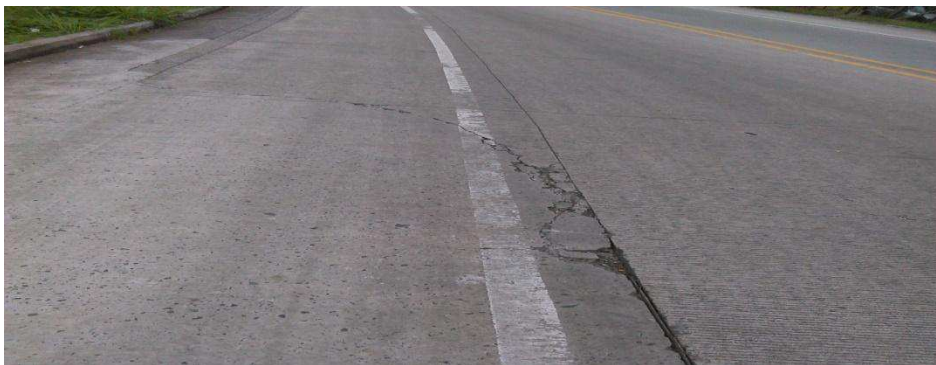
Grieta longitudinales de la vía Pavón-Flavio Abscisa 25+190
