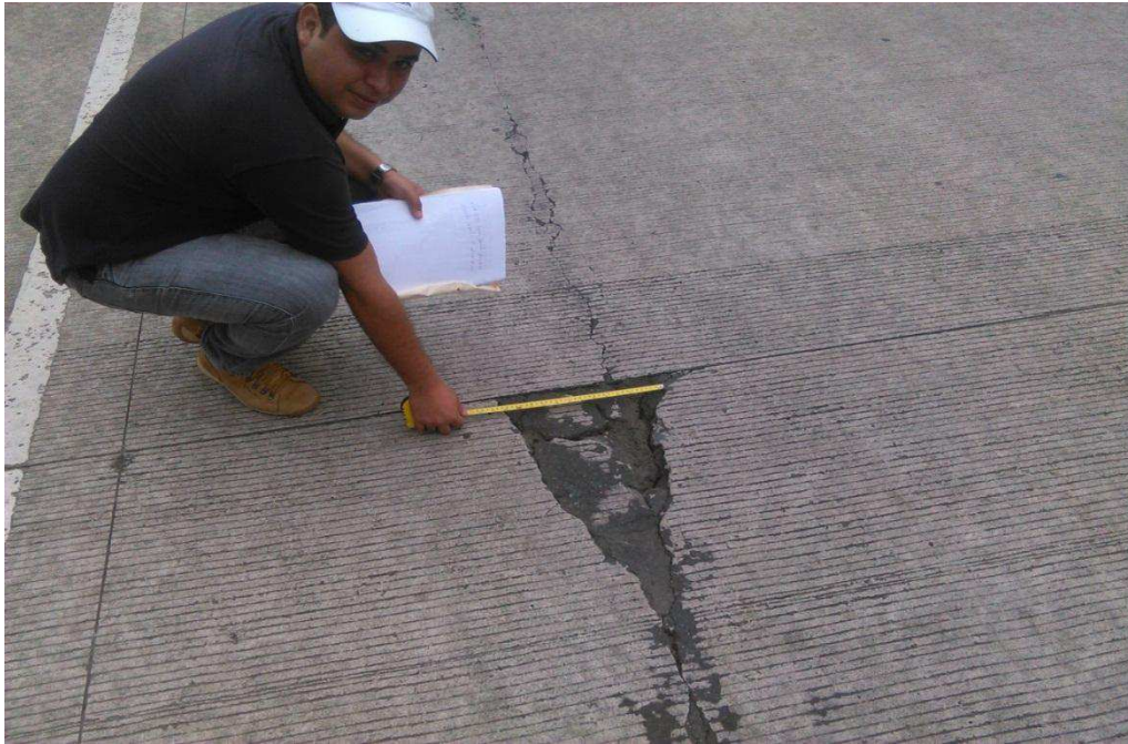
Daños en la vía Pavón-Flavio Elaboración: Los Autores
