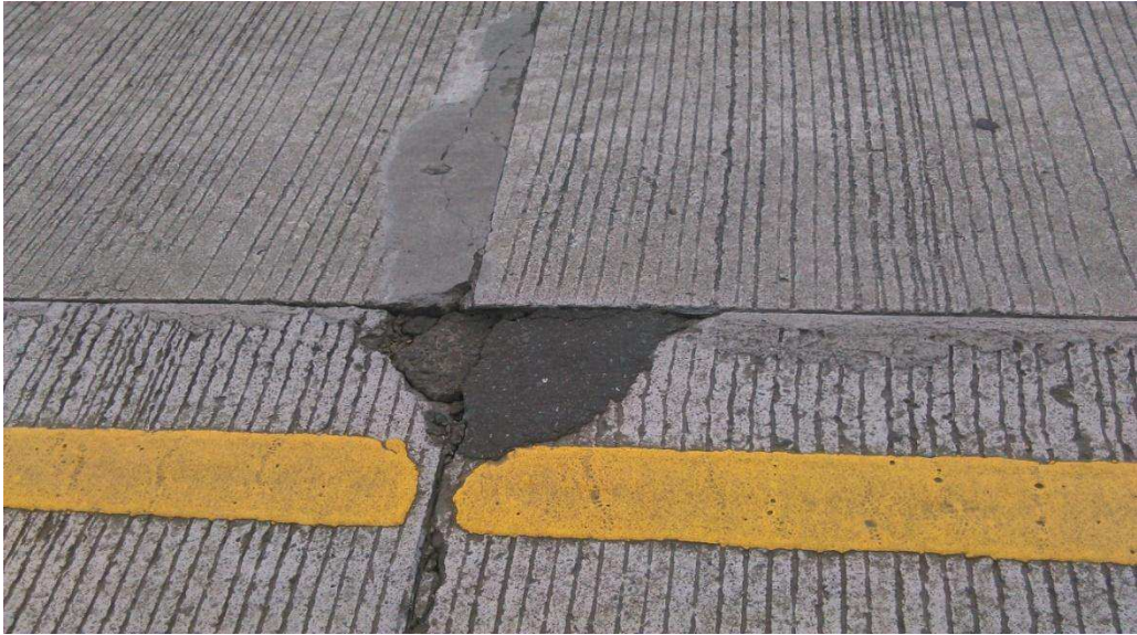
Parche deteriorado de la vía Pavón-Flavio
