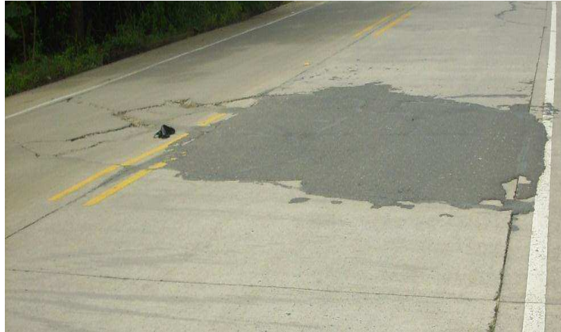
Imagen 3. Hundimiento en un tramo de la vía Pavón-Flavio Elaboración: Los Autores
