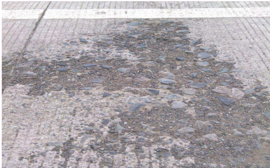
Grieta transversales de la vía Pavón-Flavio Abscisa 30+230
