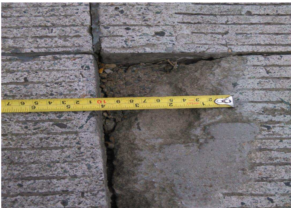
Daños en la vía Pavón-Flavio Elaboración: Los Autores
