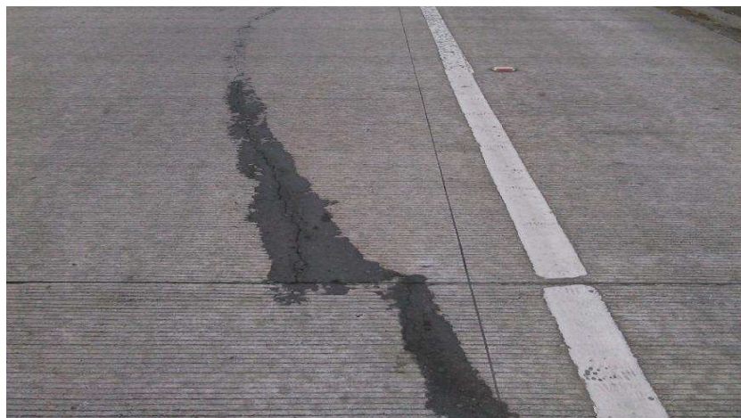
Imagen 2. Fisura longitudinal de la vía Pavón-Flavio Elaboración: Los Autores
