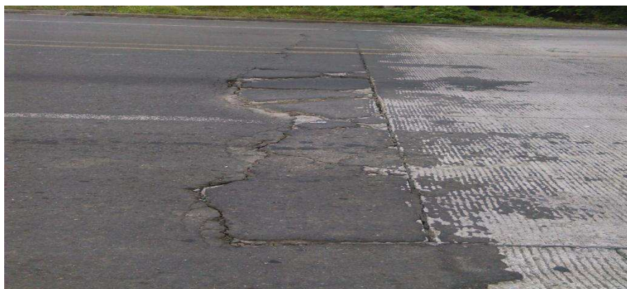
Grieta trasversales de la vía Pavón-Flavio Abscisa 28+100
