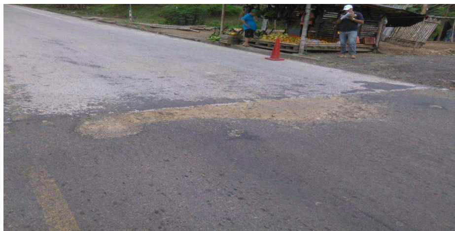
Baches de la vía Pavón-Flavio Abscisa 34+030
