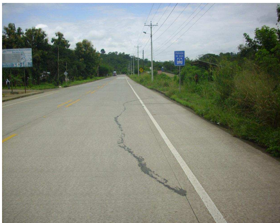
Daños en la vía Pavón-Flavio Elaboración: Los Autores
