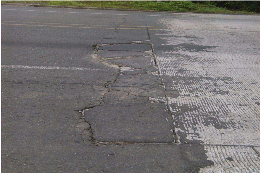
Daños en la vía Pavón-Flavio
