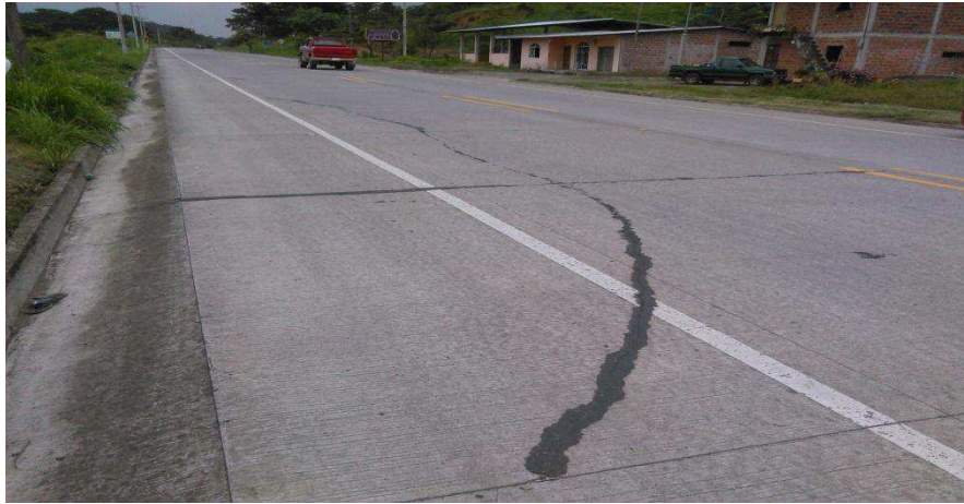
Imagen 4. Fisura transversal y longitudinal hacia la cuneta de la vía Pavón-Flavio
