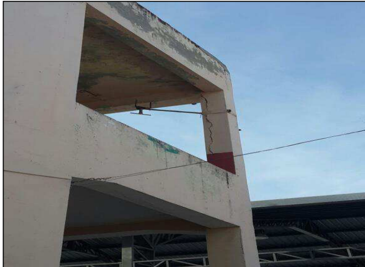
Figura N° 18. Fisuras Longitudinales Fuente: Los Autores
