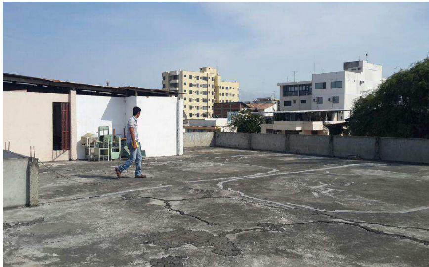
Figura N° 19. Fisuras de losa – causa de pandeo Fuente: Los Autores
