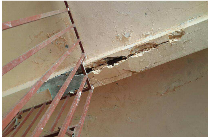
Figura N° 22. Grietas presentes en la estructura Fuente: Los Autores
