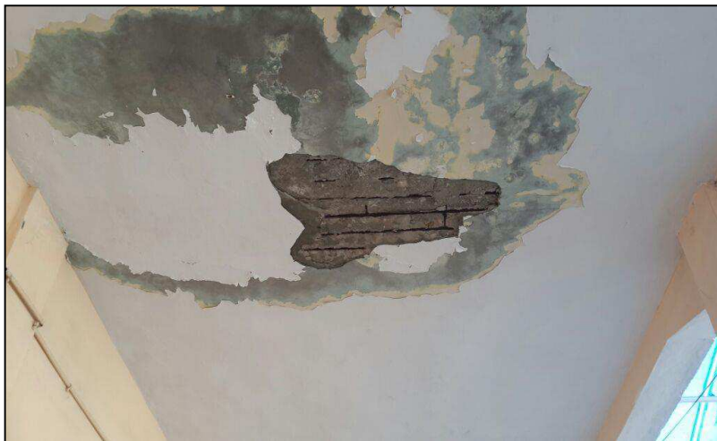
Figura N° 20. Pandeo de la losa y exposición de refuerzos Fuente: Los Autores
