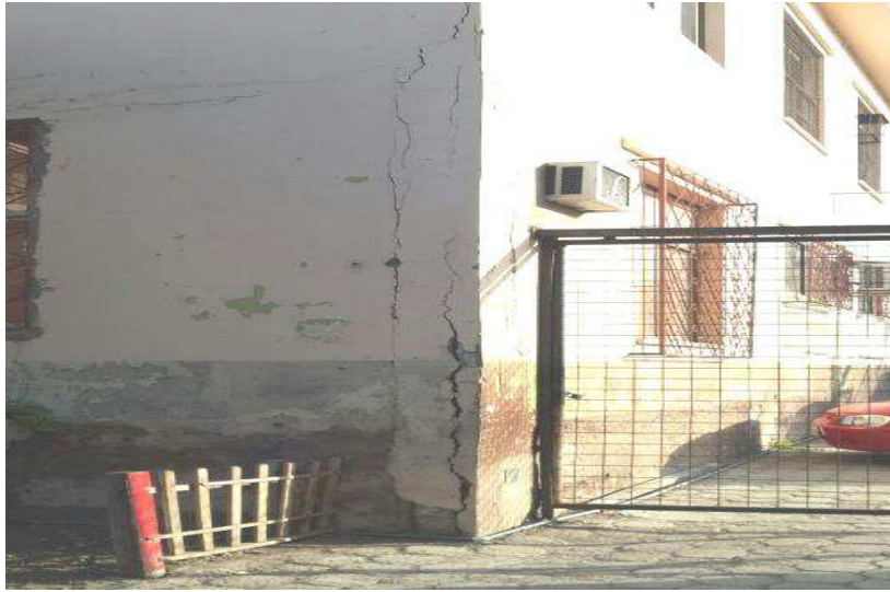
Figura N° 15. Falla por desprendimiento del hormigón Fuente: Los Autores
