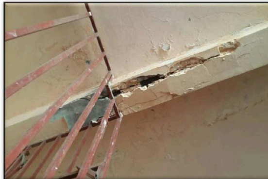
Figura N° 17. Fisuras Longitudinales Fuente: Los Autores
