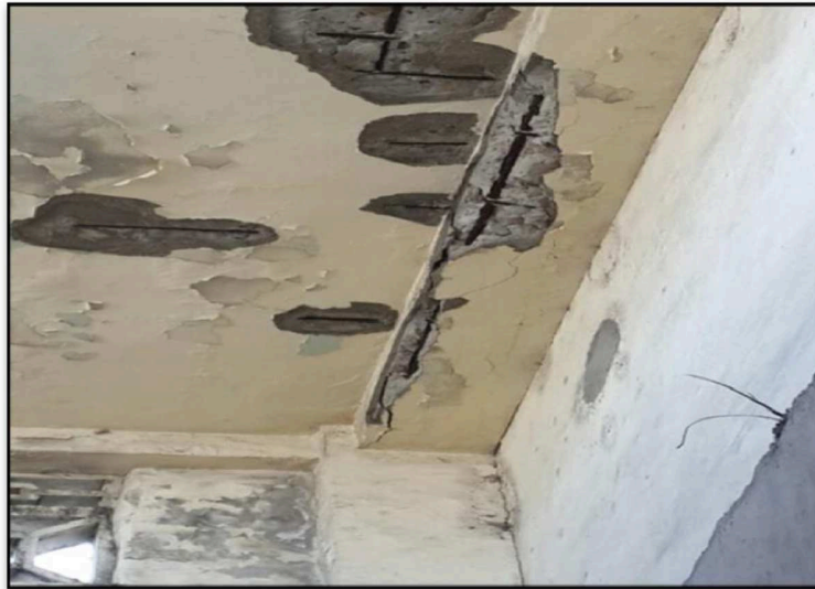
Figura N° 14. Falla por desprendimiento del hormigón Fuente: Los Autores
