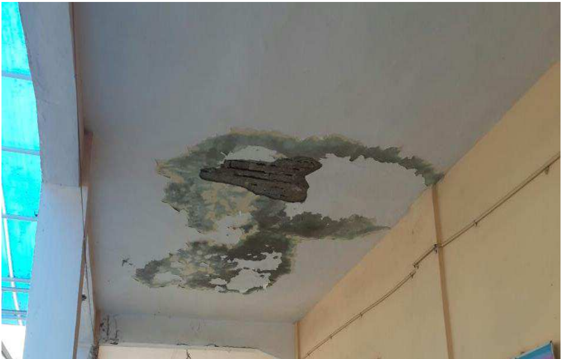
Figura 26: Se observa la estructura de la loza, es evidente el hierro en la estructura.
