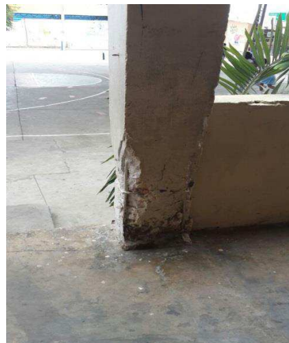
Figura N° 11. Falla por refuerzos de corte Fuente: Los Autores
