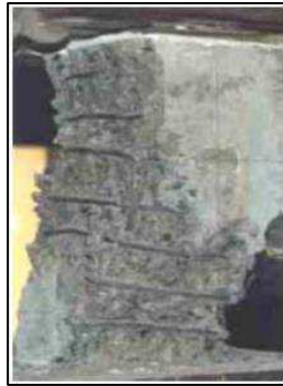
Figura N° 13. Falla por refuerzo transversal experimental Fuente: ACI 318
