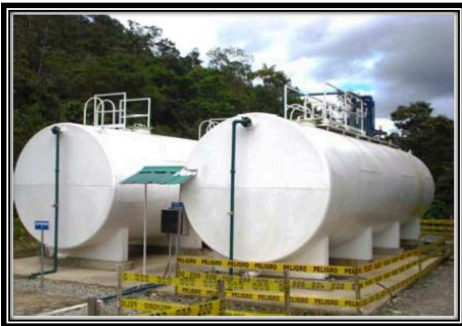
Tanques para el proceso de aireación extendida.
