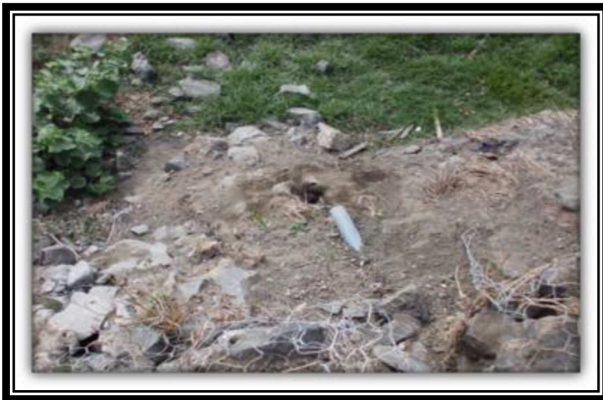
Conexión clandestina encontrada cerca del sector.
