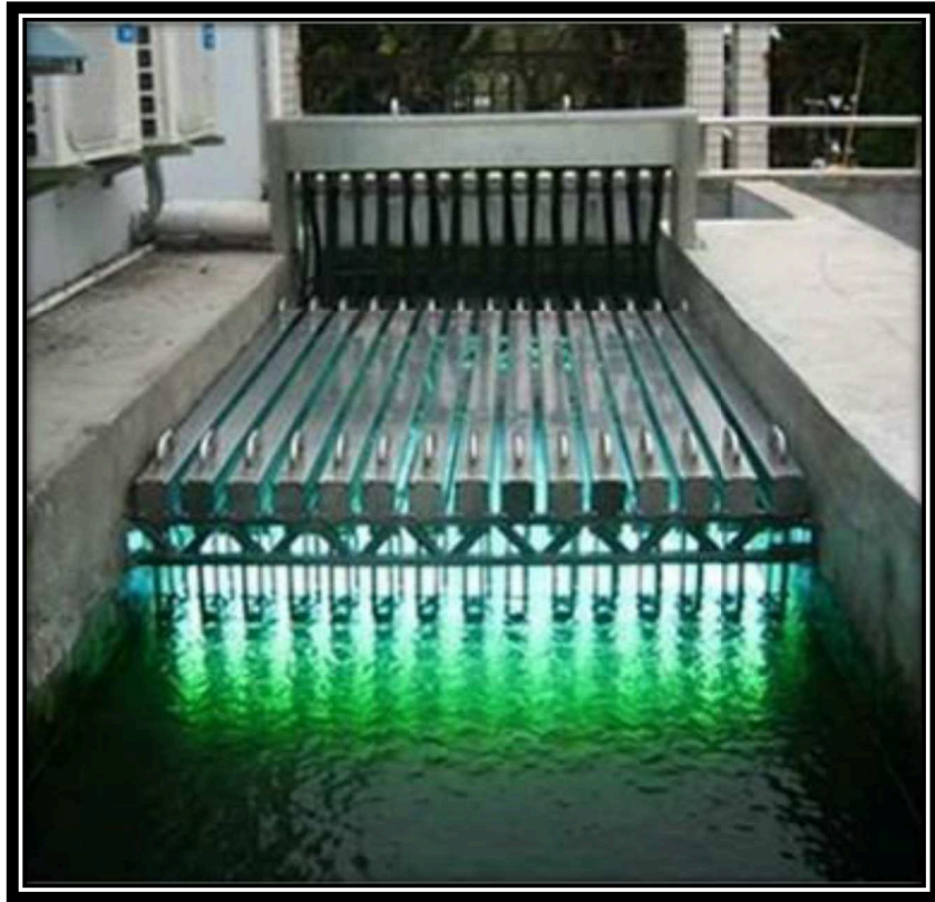
Fig. 2.8 Sistema de desinfección con rayos UV.
