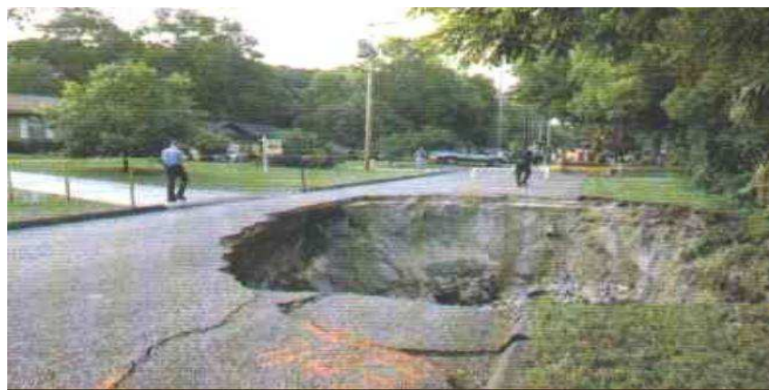
Falla provocada por la filtración del agua de una laguna en suelos dispersivos en Orlando, Florida
