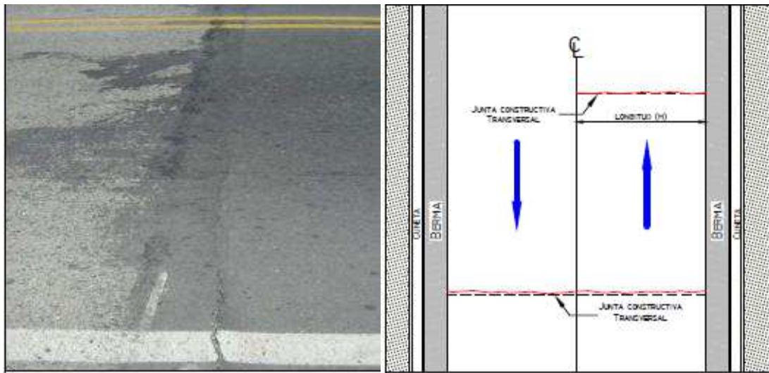
FIGURA 2.5.1.2- Fisuras en Juntas de Construcción Transversal
