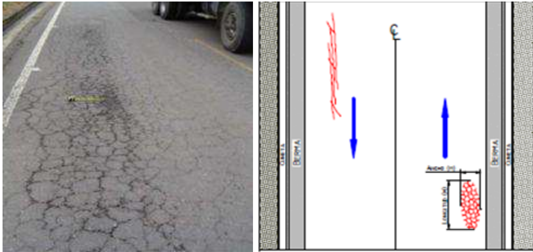
FIGURA 2.5.1.7- Fisura Piel de Cocodrilo
