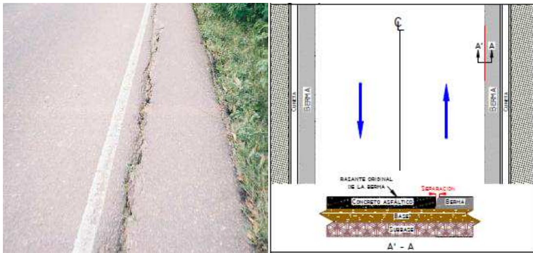
FIGURA 2.5.5.2- Separación de la Berma
