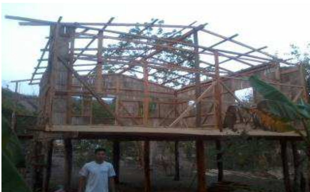
Estructura de madera que fue tomada como guía para nuestro diseño. Elaborado por: Los Autores.
