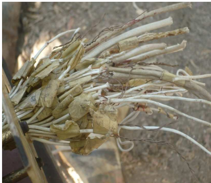
Figura 42. Cables de conexión
