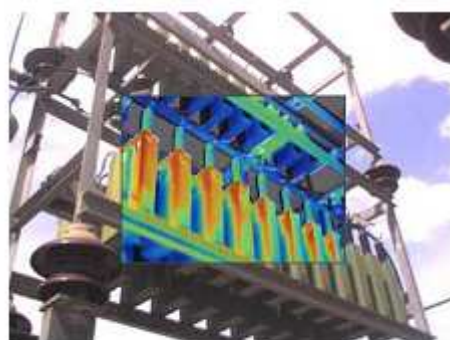
Termografía con tecnología IR Fusión de una batería de condensadores
