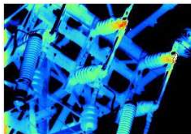
Inspección cualitativa. Se compara la temperatura de los elementos de las tres fases
