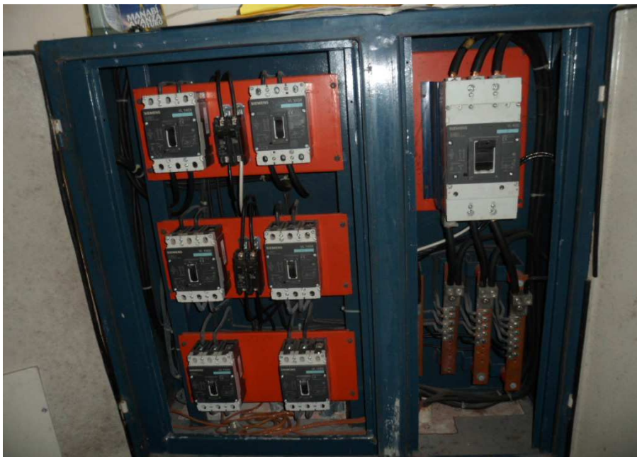
CENTRO DE TRANSFORMACION # 1
