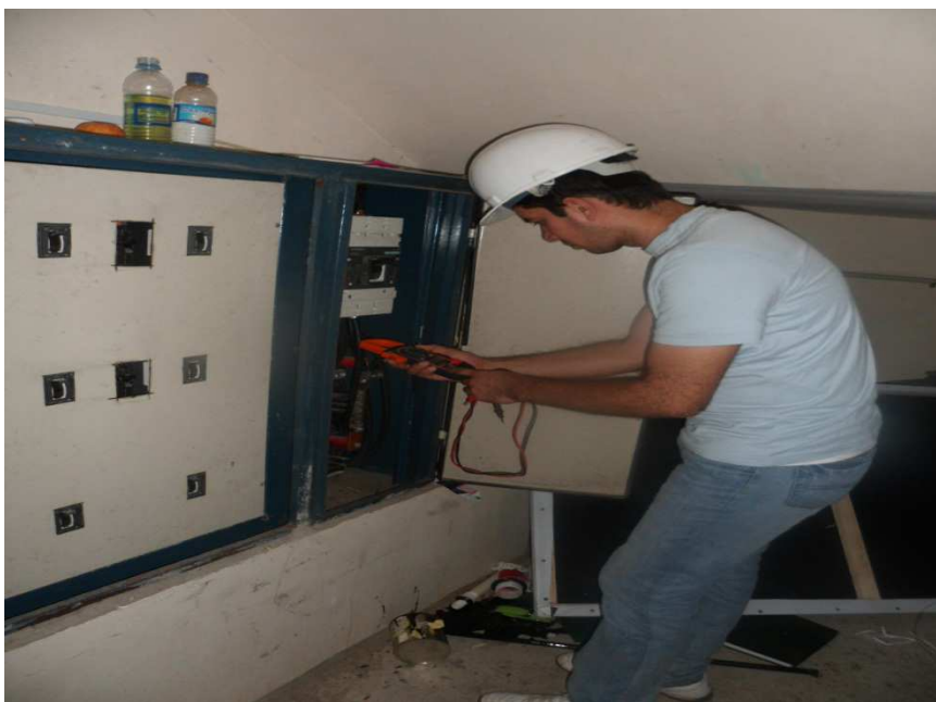
PROTECCION GENERAL CENTRO DE CARGA N°1
