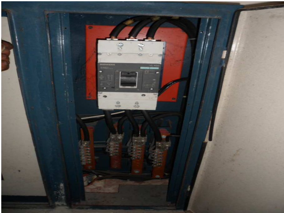
CENTRO DE CARGA # 1
