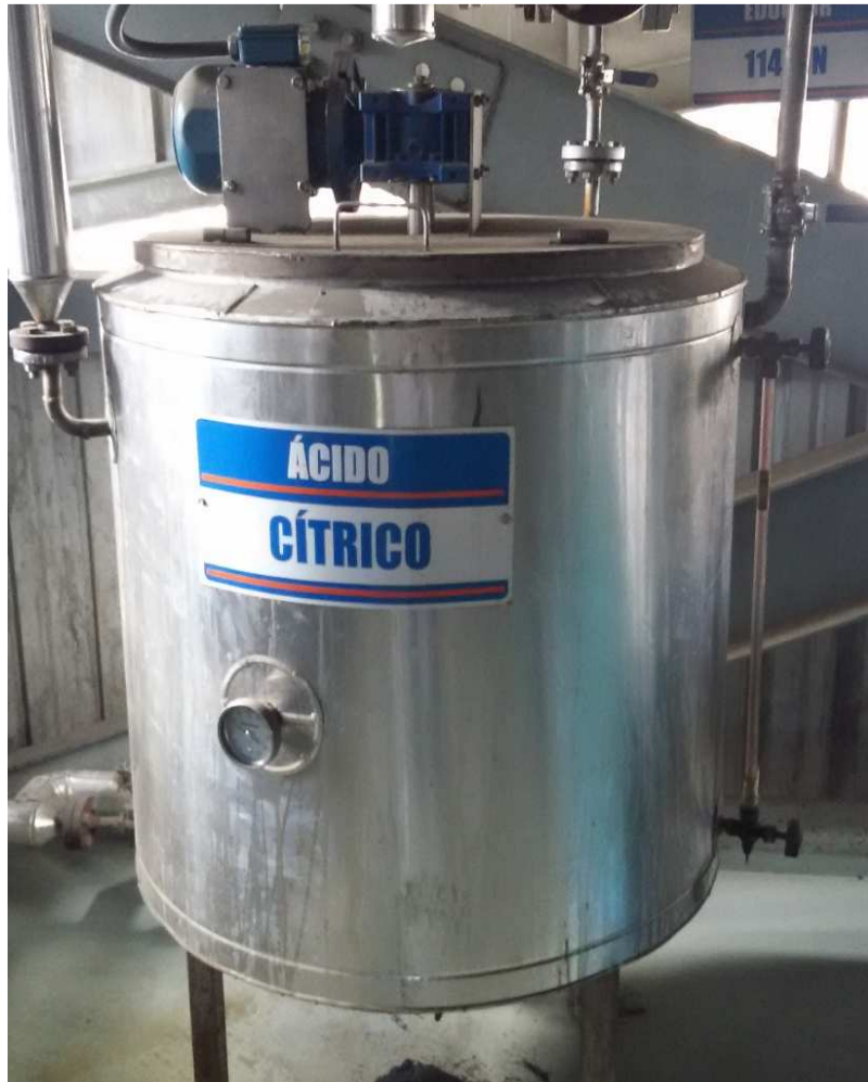
Ilustración 35. Tanque para limpieza (Cortesía de La Fabril).
