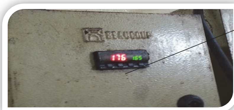
Ilustración 7 Cámara de Frio
