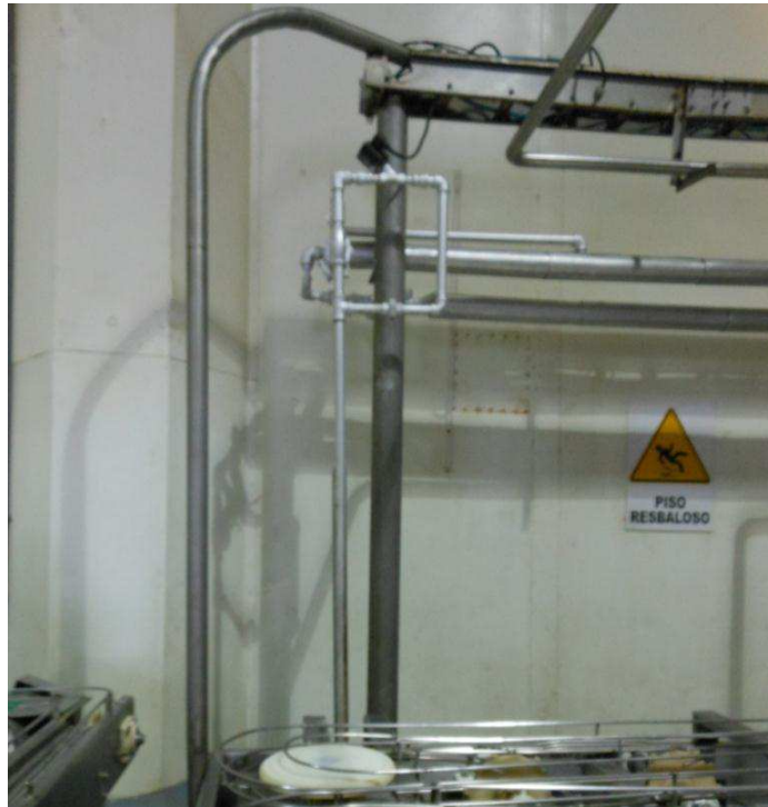
Imagen No. 10 Tubería que alimenta a la Dosificadora
