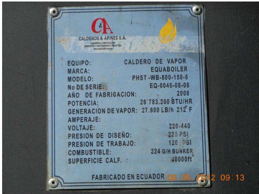
Imagen No. 2 Caldero de 800 BHP
