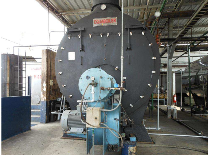
Imagen No. 1 Caldero de 600 BHP
