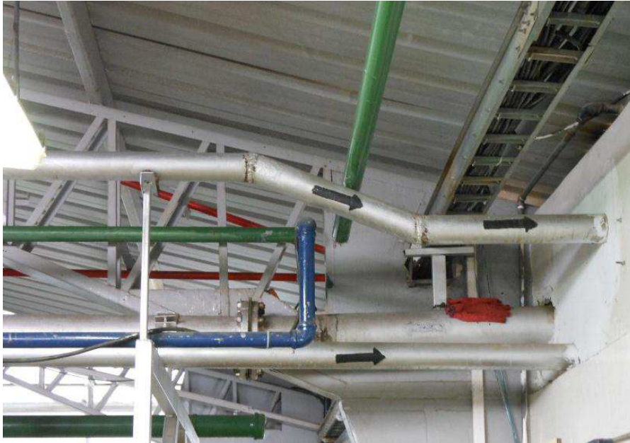
Imagen No. 11 Tubería matriz que alimenta a los autoclaves
