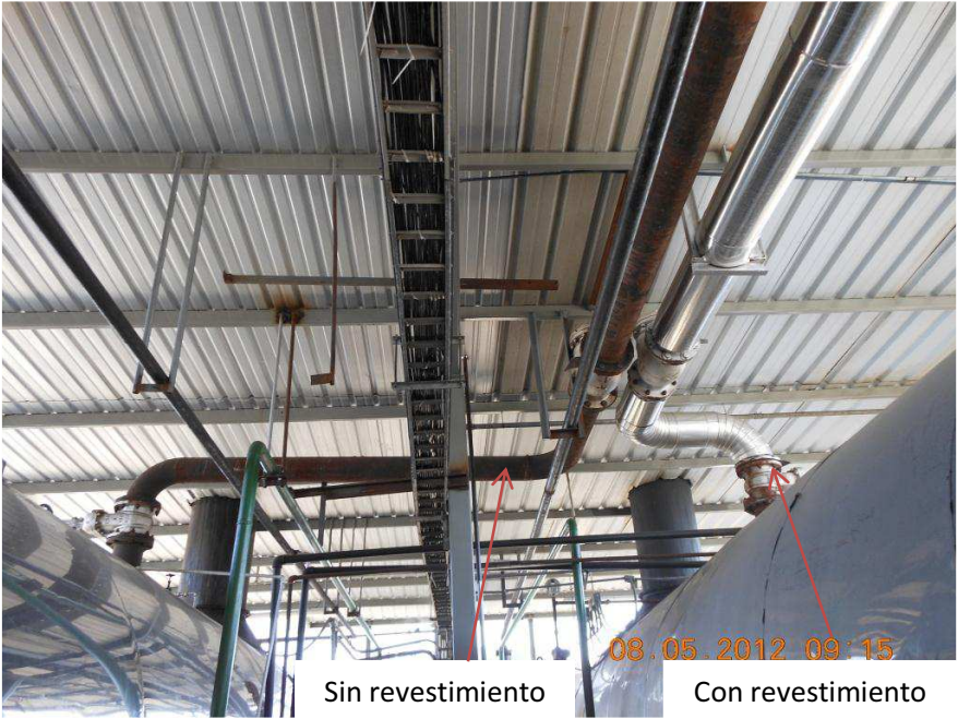
Imagen No. 4 Tuberías matriz de los Calderos
