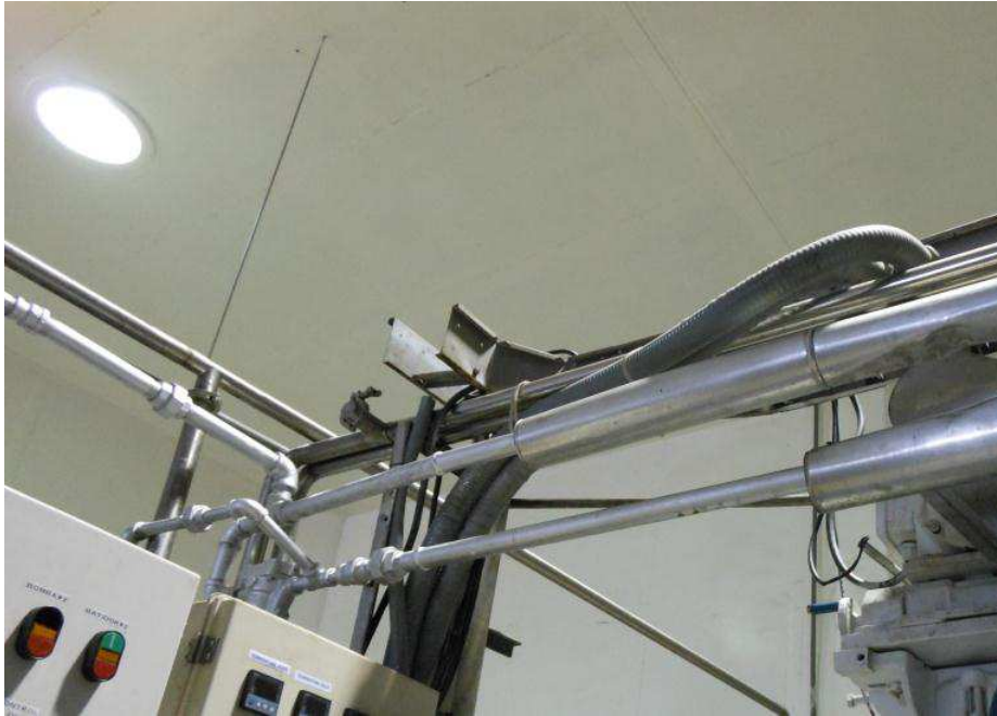
Imagen No. 9 Tubería que alimenta a las marmitas
