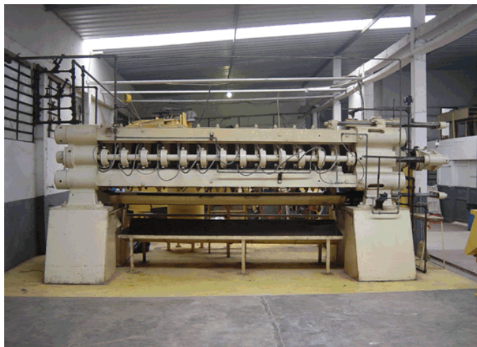
(Figura 10.- Tanque de precalentamiento de agua y sistema de distribución de vapor)
