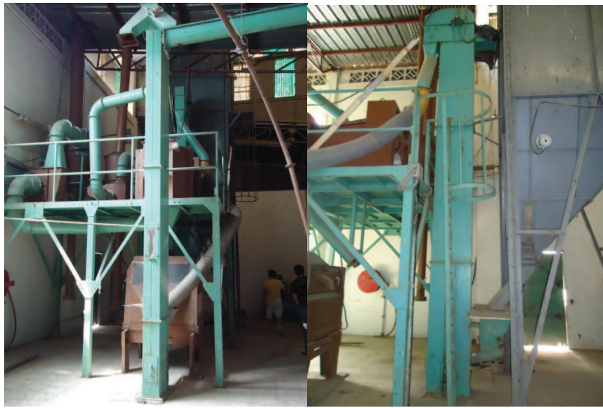
(Figura 1.- Equipo de torrefacción y limpieza de Manacoa S.A.)
