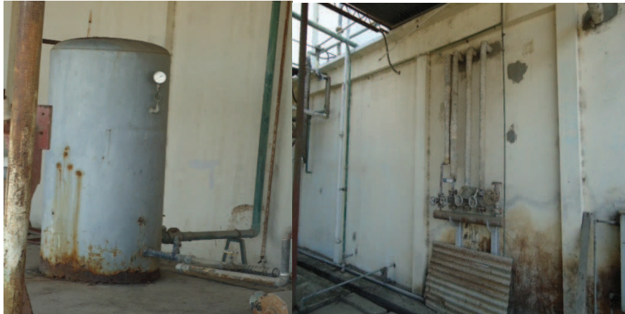
(Figura 9.- Tanque de precalentamiento de agua y sistema de distribución de vapor)
