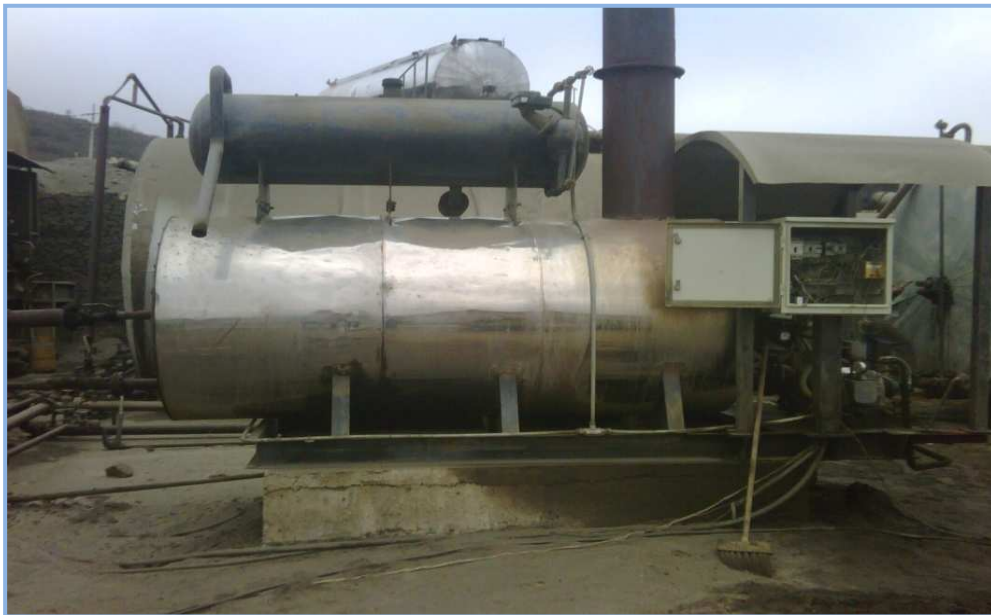
Fotografía #9 muestra el caldero de aceite térmico de la planta.
