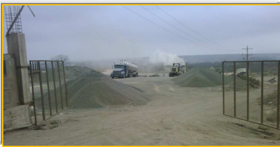
Fotografía #6. Muestra el material de agregados mal ubicado generando polvo en exceso.
