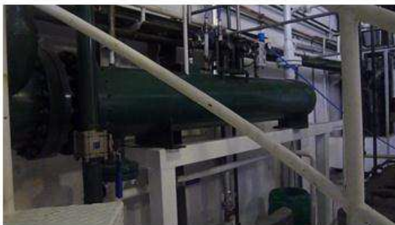
CONDENSADOR CON BOMBA DE VACIO NEUMATICA
