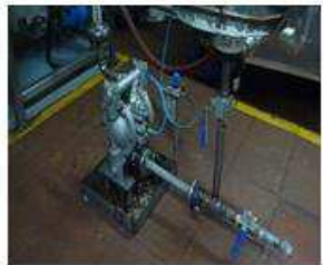
BOMBA DE RE CIRCULACION
