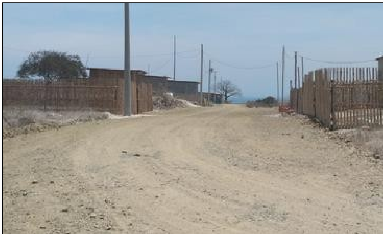
Anexo 6 Fotografía del estado de las vías internas en la etapa 3 del programa Ceibo Renacer
