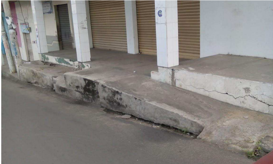
Foto 10 – Barreras arquitectónicas en av. 4 Fuente: Investigación de Campo Autor: Tesista
