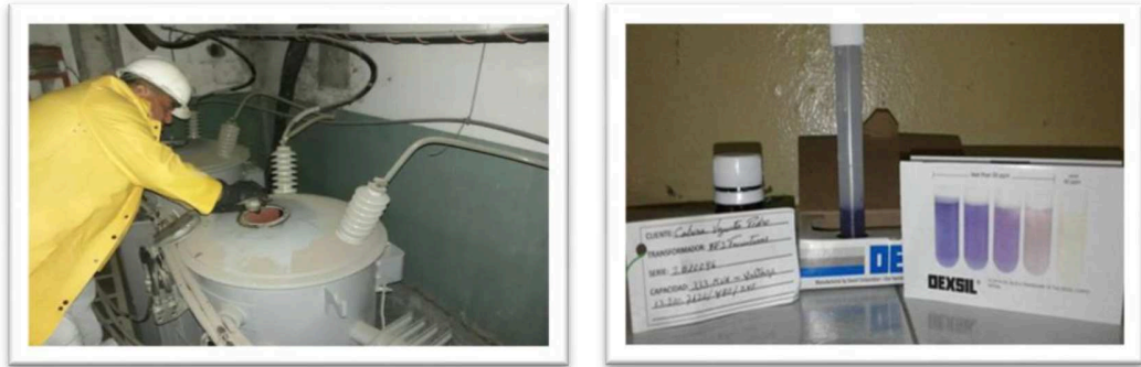
Gráfico 24: Transformador Marca Tecnitrans, serie (2010096)
