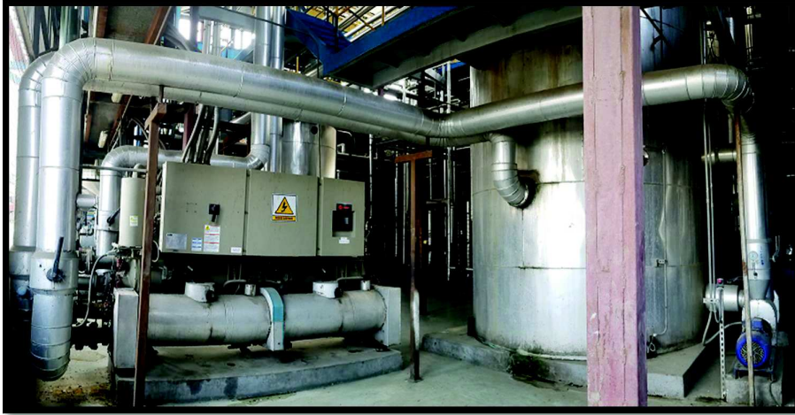
Figura 41. Unidad de enfriamiento (Chiller) y tanque de agua B/C Fuente: Auditoría energética
