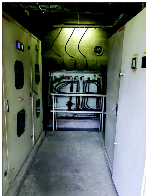
Figura 17. Transformador de Fraccionamiento 5 y 6 Fuente: Auditoría energética
