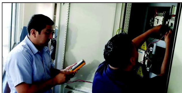
Figura 54. Medición eléctrica en tablero Fraccionamiento 6 Fuente: Auditoría energética
