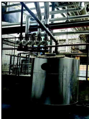
Figura 27. Tanque colector de condensados de Planta de Fraccionamiento Fuente: Auditoría energética
