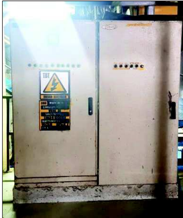
Figura 19. Tablero secundario para iluminación Fuente: Auditoría energética
