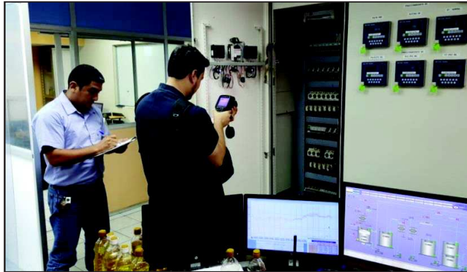
Figura 51. Medición infrarroja de tablero Fraccionamiento # 5 Fuente: Auditoría energética
