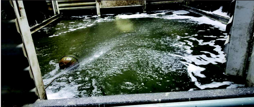
Figura 39. Bandeja de recepción y enfriamiento del agua Fuente: Auditoría energética
