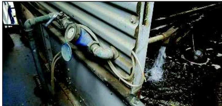
Figura 7. Medidor de agua en torres de Planta de Fraccionamiento Fuente: Auditoría energética
