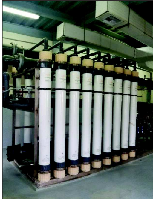
Figura 31. Sistema de filtración del agua Fuente: Auditoría energética
