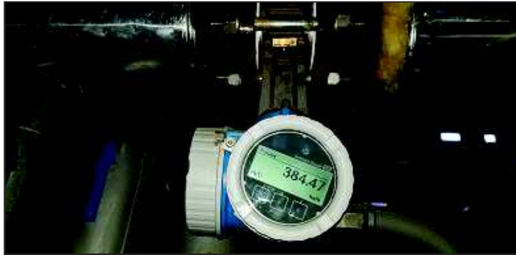
Figura 6. Flujometro de vapor Fraccionamiento 7 Fuente: Auditoría energética
