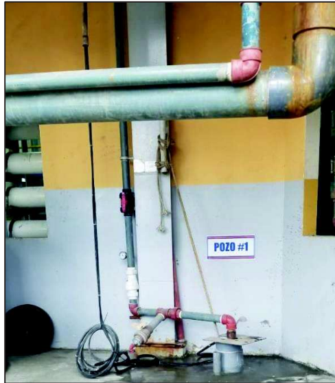
Figura 29. Pozo profundo Fuente: Auditoría energética
