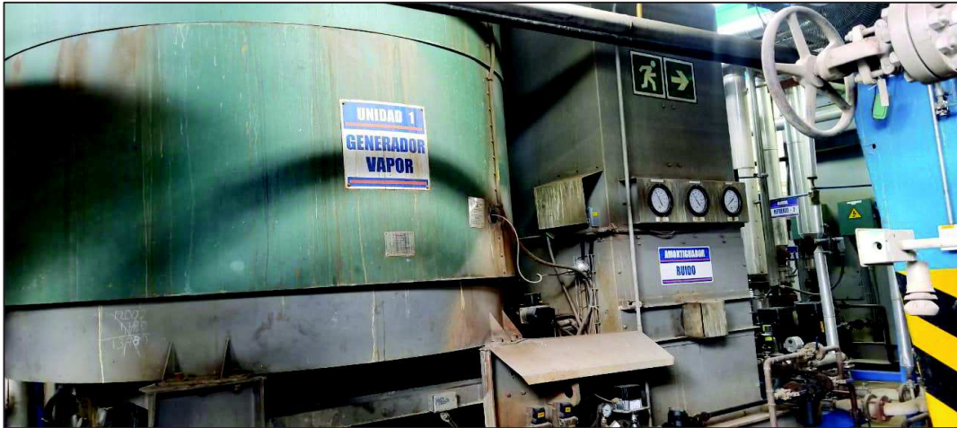
Figura 21. Generador de vapor Fuente: Auditoría energética
