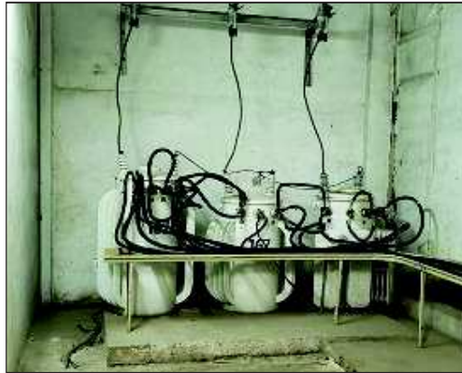
Figura 16. Transformadores de Fraccionamiento 2 y 3 Fuente: Auditoría energética
