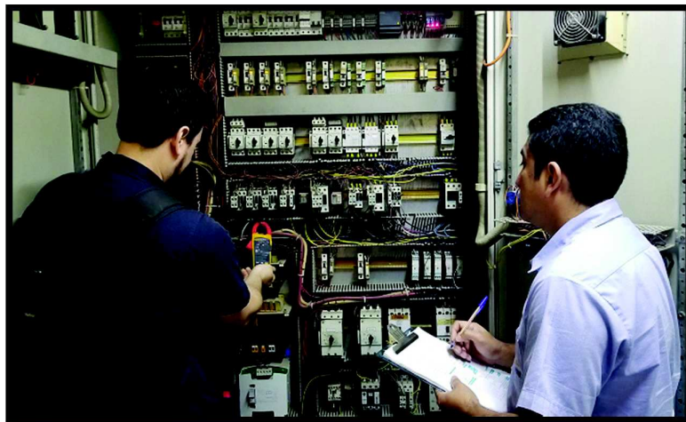
Figura 48. Medición eléctrica en tablero Fraccionamiento # 3 Fuente: Auditoría energética
