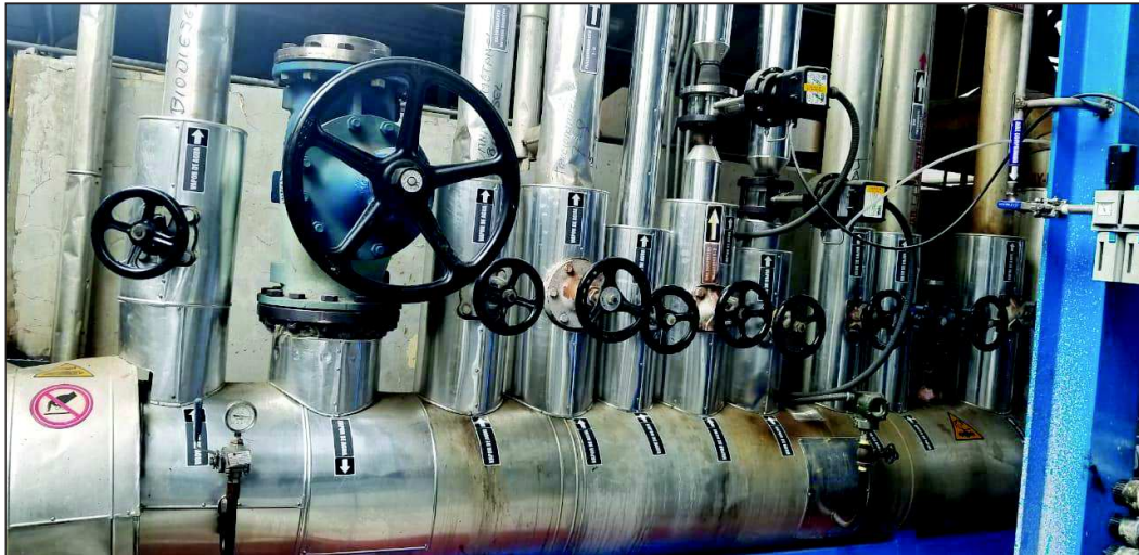
Figura 22. Distribuidor de vapor principal Fuente: Auditoría energética
