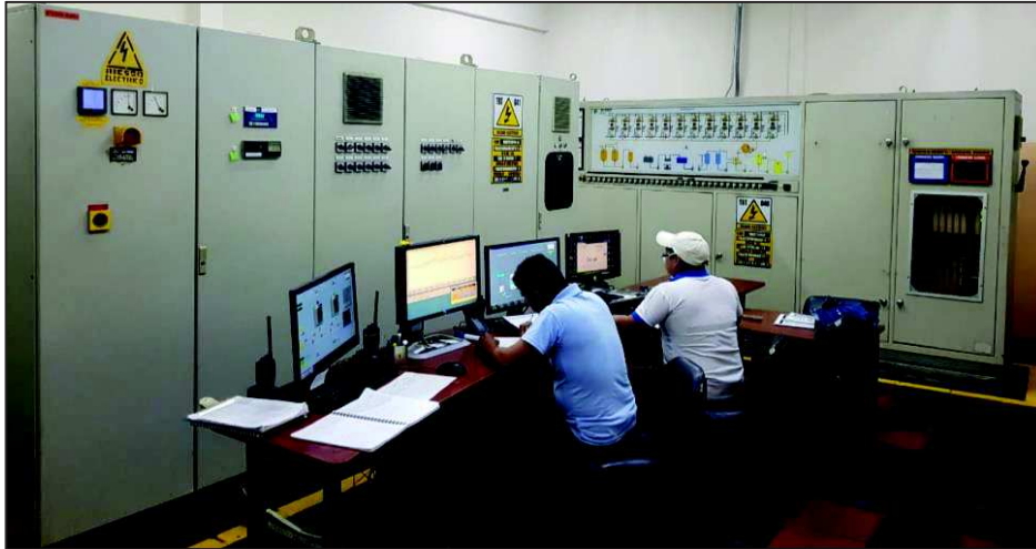
Figura 18. Punto de control de consumo de energía Fuente: Auditoría energética
