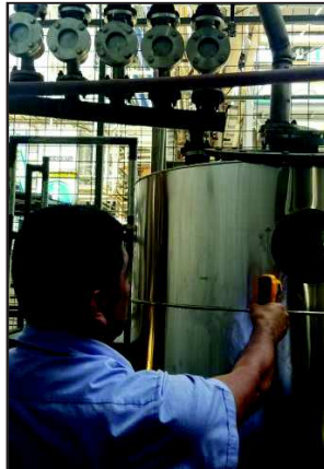
Figura 57. Medición de temperatura tanque de condensados Fuente: Auditoría energética
