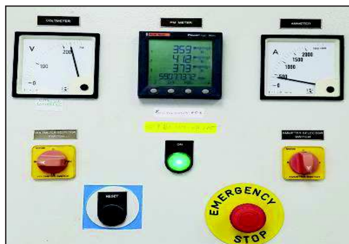
Figura 5. Punto de medición energía eléctrica de Fraccionamiento 5 Fuente: Auditoría energética
