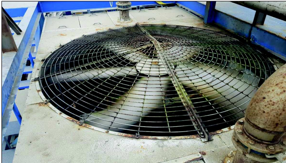
Figura 40. Ventilador de la torre de enfriamiento Fuente: Auditoría energética
