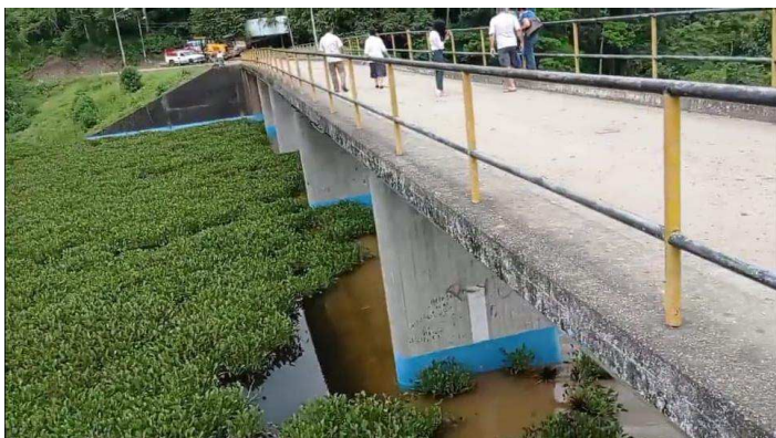
Vertedero con gran presencia de lechuguinos estancados.
