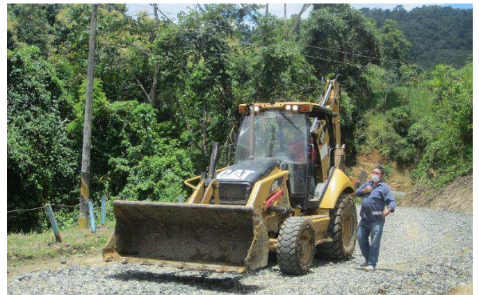
Diálogo con Operador de Maquinaria del G.A.D Parroquial de Honorato Vásquez sobre las problemáticas que presentan las vías del sector.
