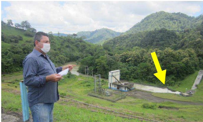
Salida de agua de los túneles de la Represa Poza Honda.
