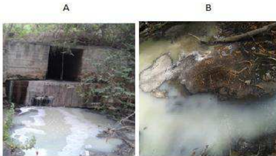
Figura 1. Efluente de ULEAM en quebrada (A) alcantarilla de salida (B) acumulación de materia orgánica.
