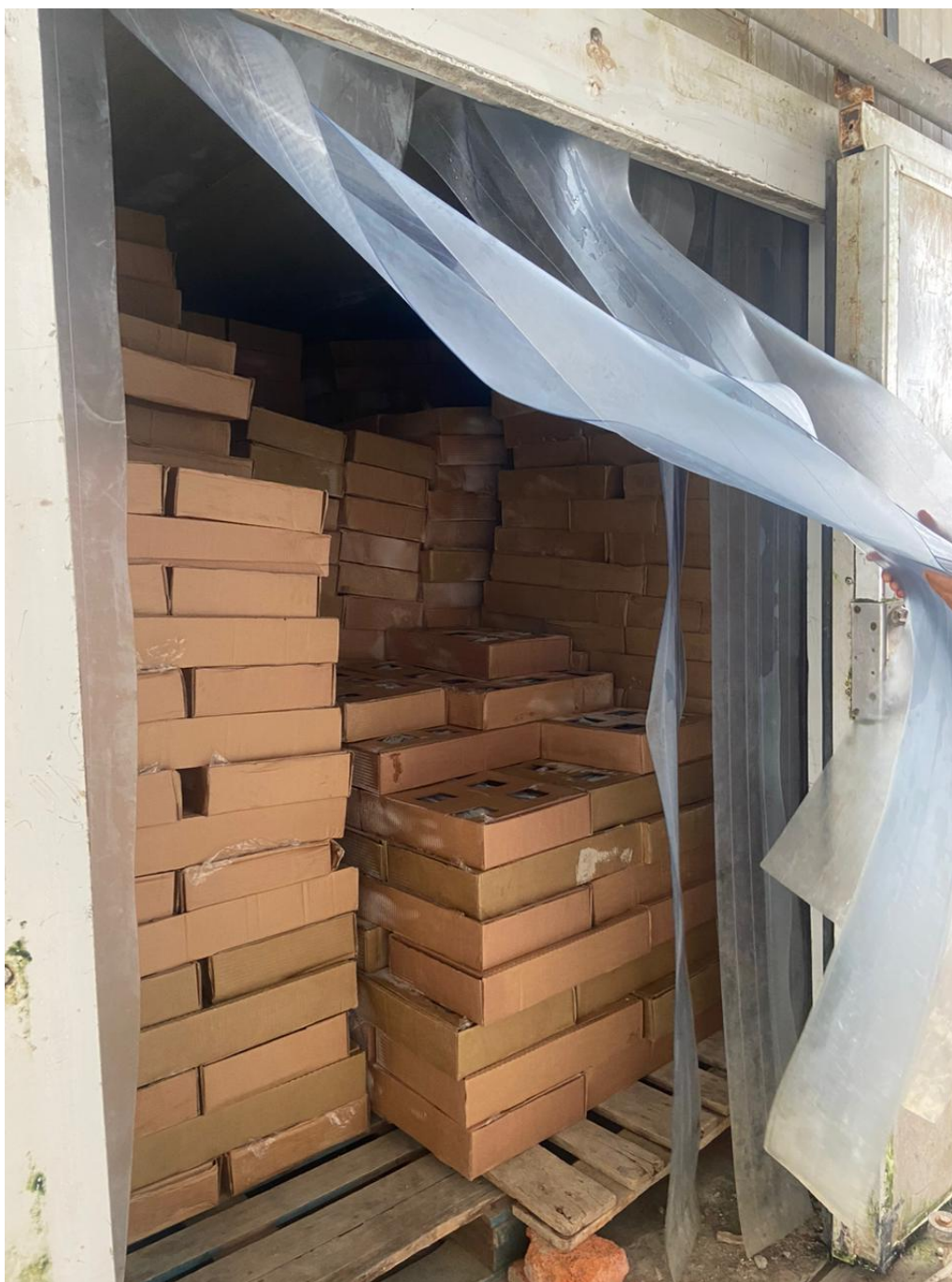
Interior de cámara de fresco de 7.5HP Congeland para el mantenimiento de producto terminado.
