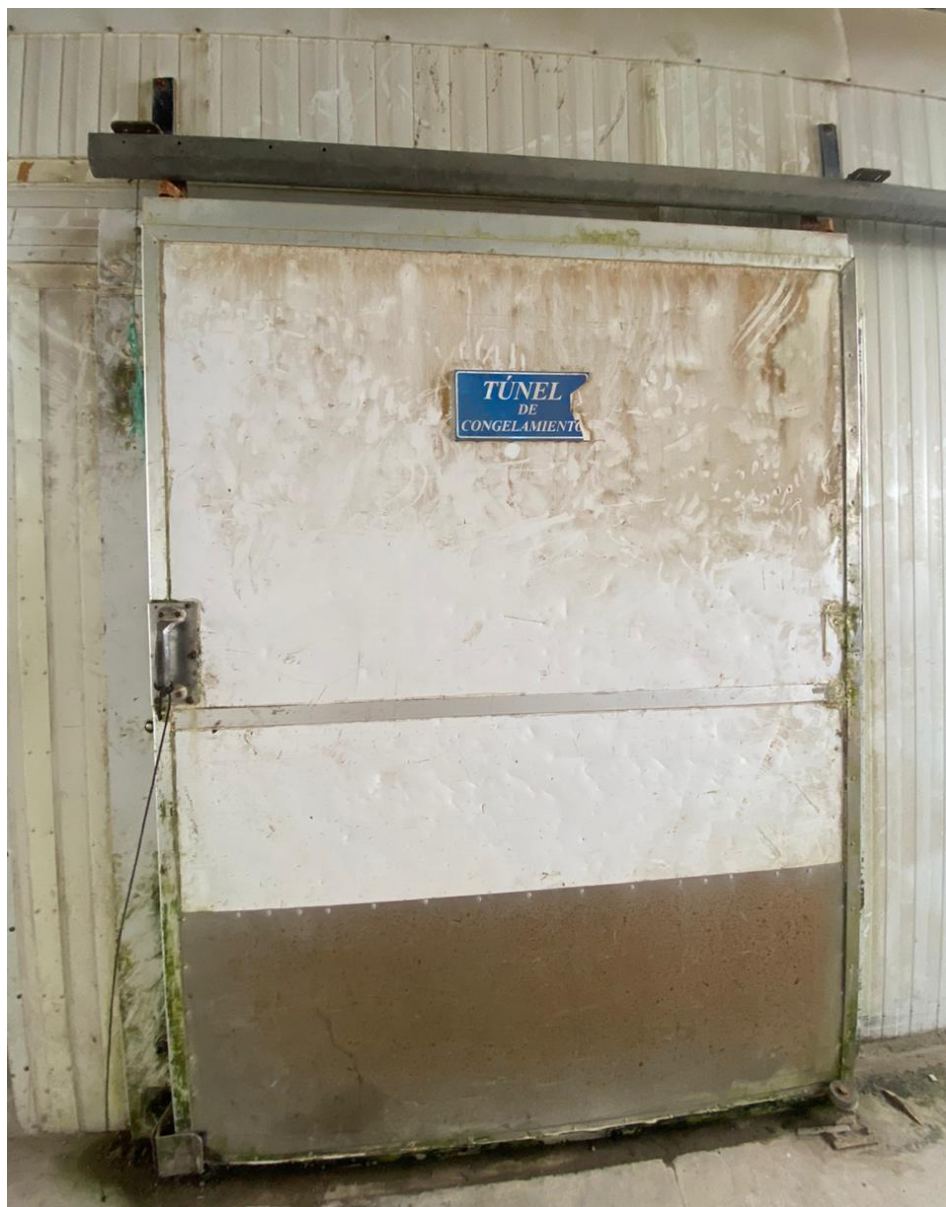
Túnel de congelamiento de 30HP Congeland para producción de carnada.
