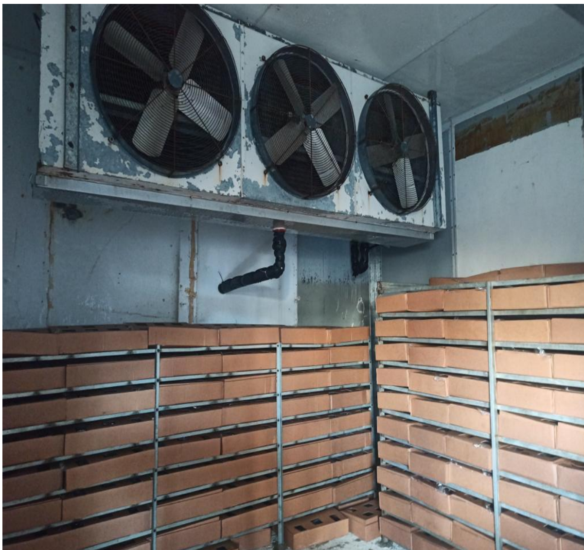
Interior de tunel de congelamiento de 30 HP Congeland para produccion de carnada.
