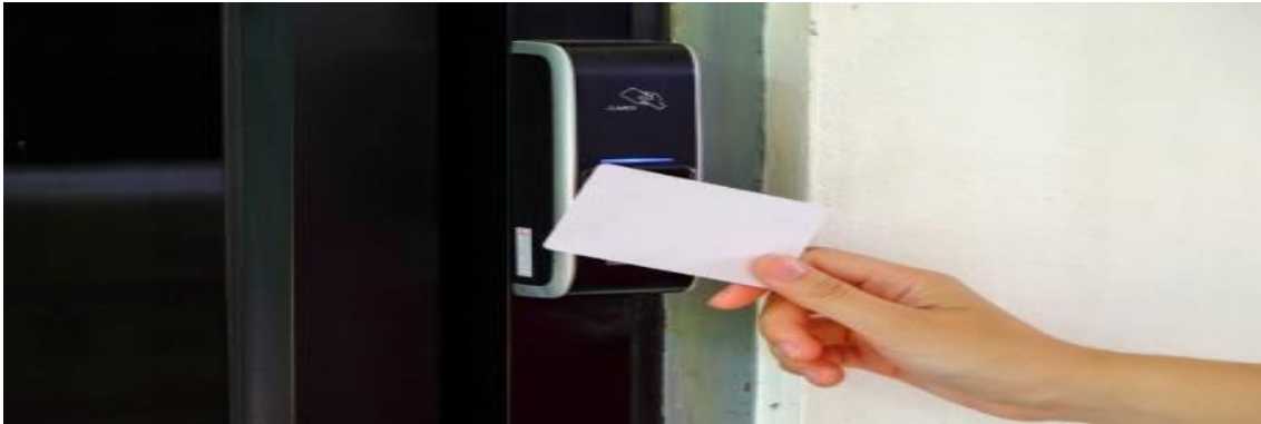
Ilustración 1 Control de acceso automático Fuente: (Coldomótica, 2018)
