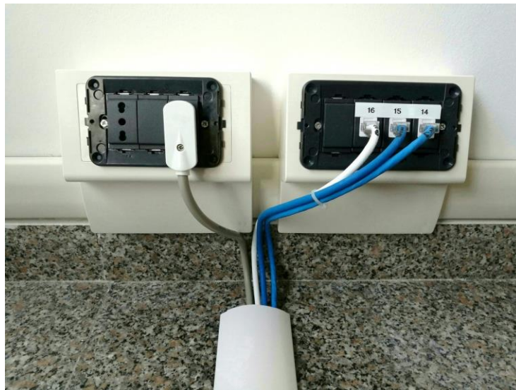
Figura N° 24: Canaleta de recubrimiento para los cables de conectores a el computador y el switch
