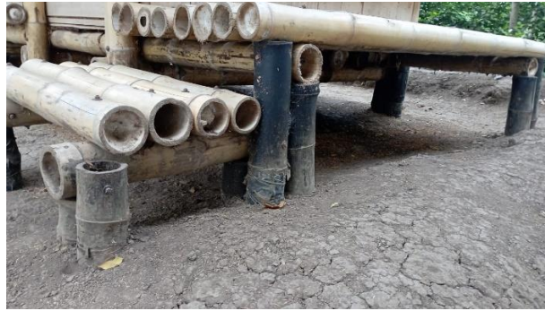
Ilustración 17 Soportes para el paso del personal
