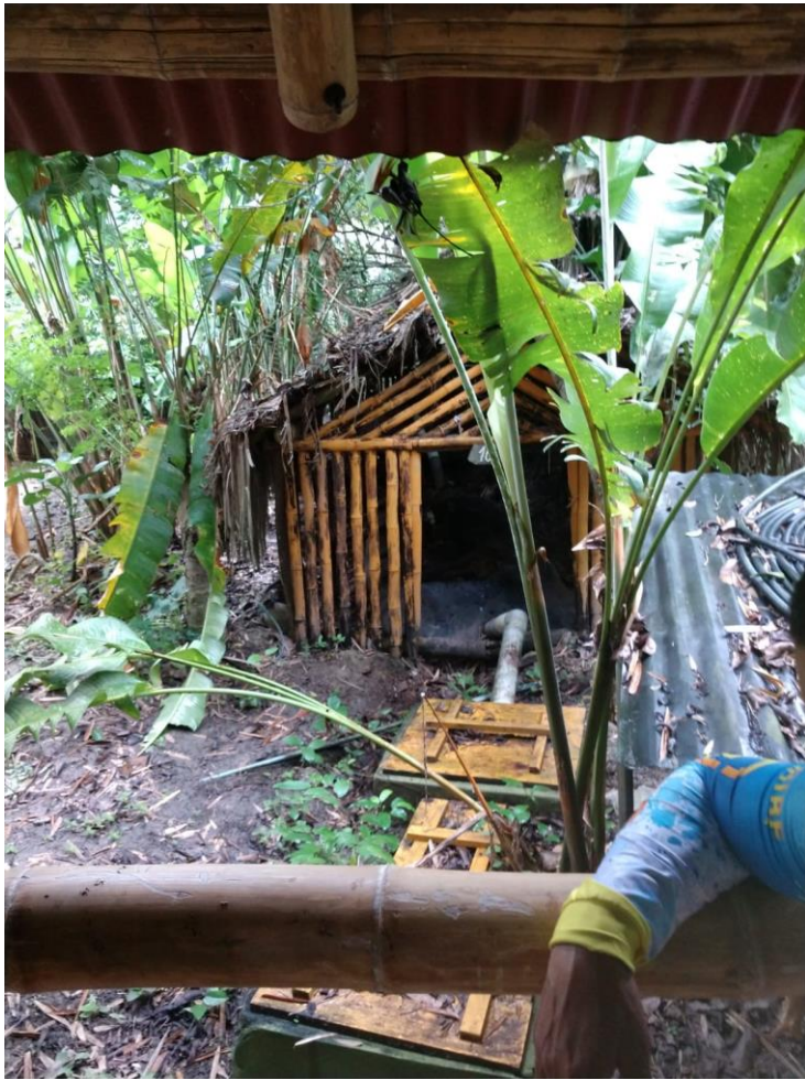
Sistema de limpieza de agua residual de lavandería, ecolodge “Río Muchacho”.
