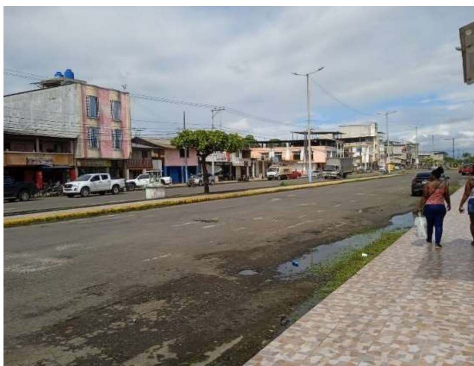
Imagen N.º 34: Estado de parterres y calzada.
