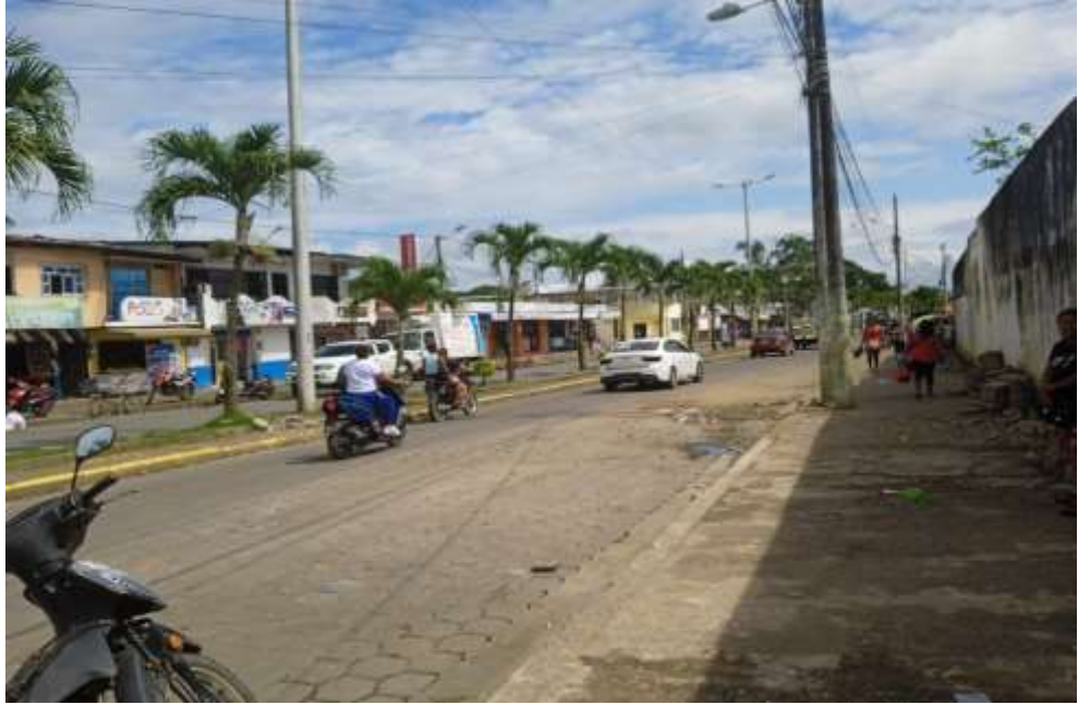
Imagen N.º 55: Estado de acera y calzada
